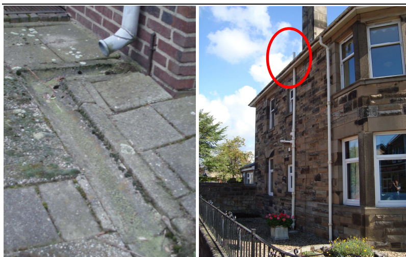
Links: Bovengrondse afstroming naar de straat middels bochtstuk en gootje bij woning Brachterbeek. Rechts: Vuilwater-standleiding (en verzamelleiding) aan buitenzijde gebouw met ontluchting doordat de buis tot boven de dakgoot is gerealiseerd (voorbeeld Inverness, Schotland).
