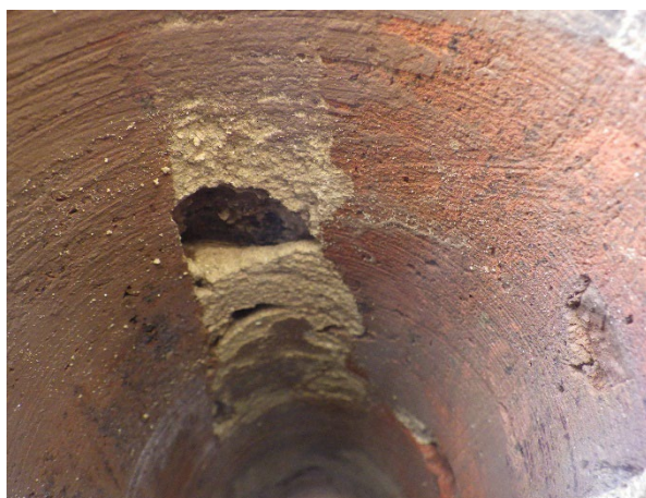
Figuur 3.16: Boorgat met holle ruimte in voeg
