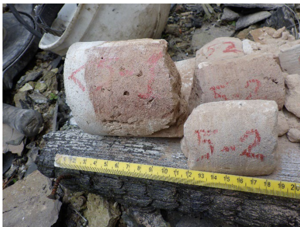
Figuur 3.33: Binnenzijde. Geen verkleuring of schade door brand. Kern verbrokken. Breukvlakken door stenen heen
