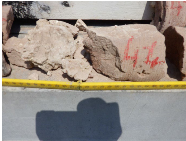
Figuur 3.28: Metselwerk, verbrokkeld
