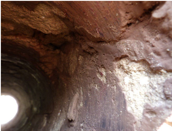
Figuur 3.9: Boorgat rechts, boven, metselwerk lijkt plaatselijk gescheurd
