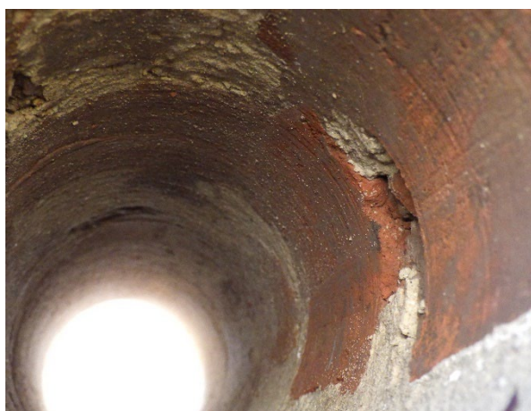
Figuur 3.18: Boorgat rechts met holle plekken
