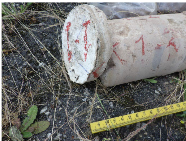
Figuur 3.7: 1-1, buitenzijde. Pleisterlaag laat los
