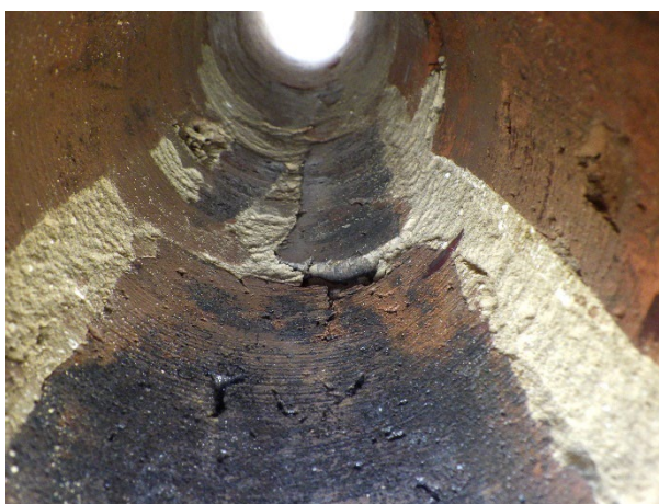
Figuur 3.17: Onderzijde boorgat, enkele scheurtjes
