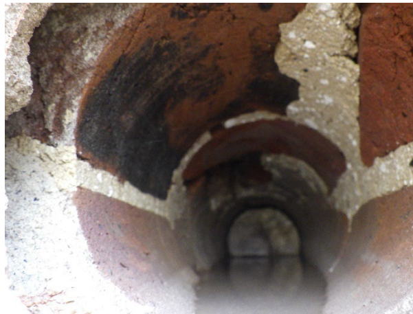
Figuur 3.30: Boorgat 4 met holle ruimte in metselwerk
