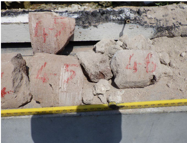
Figuur 3.29: Overig metselwerk verbrokkeld
