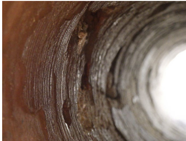
Figuur 3.10: Boorgat links, holle plekken in voegen tussen de stenen
