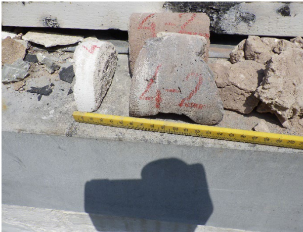
Figuur 3.27: Deel 4-1 en 4-2, pleisterlaag laat los, kern verbrokkeld. Geen brandschade zichtbaar
