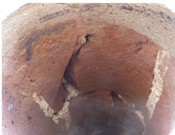
Figuur 3.36: Holle plekken en ontbrekende voegen te zien in het boorgat
