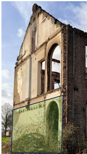
Te handhaven metselwerk oostelijke gevel klooster vleugel.
