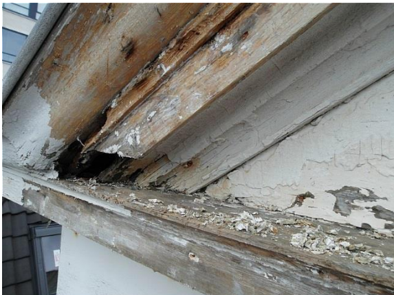
Verval door achterstallig onderhoud
