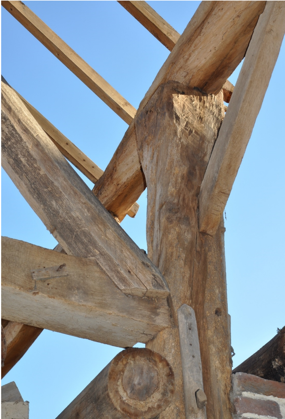
Afb. 36. De kap- en gebintconstructie van boerderij de Broasheuf tijdens de restauratie. Bij planvorming en herstel van een monument is deskundigheid nodig.
