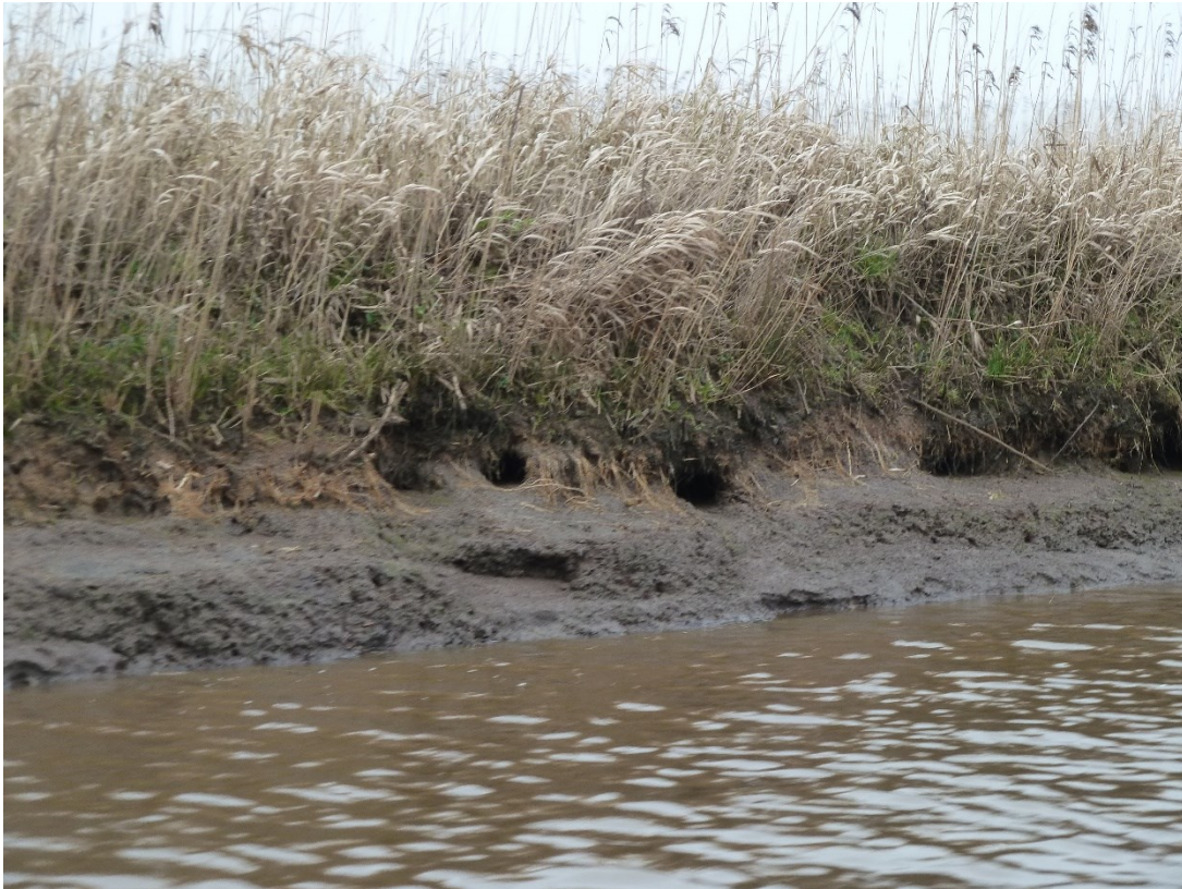
Schade aan de oever door beverratten
