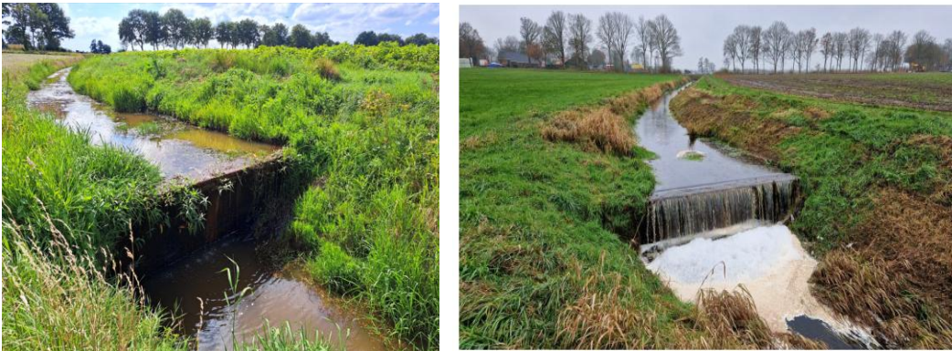
Figuur 2-17 Lagestroetenoverlaat. Links foto d.d. augustus 2025 en rechts d.d. eind november 2025
