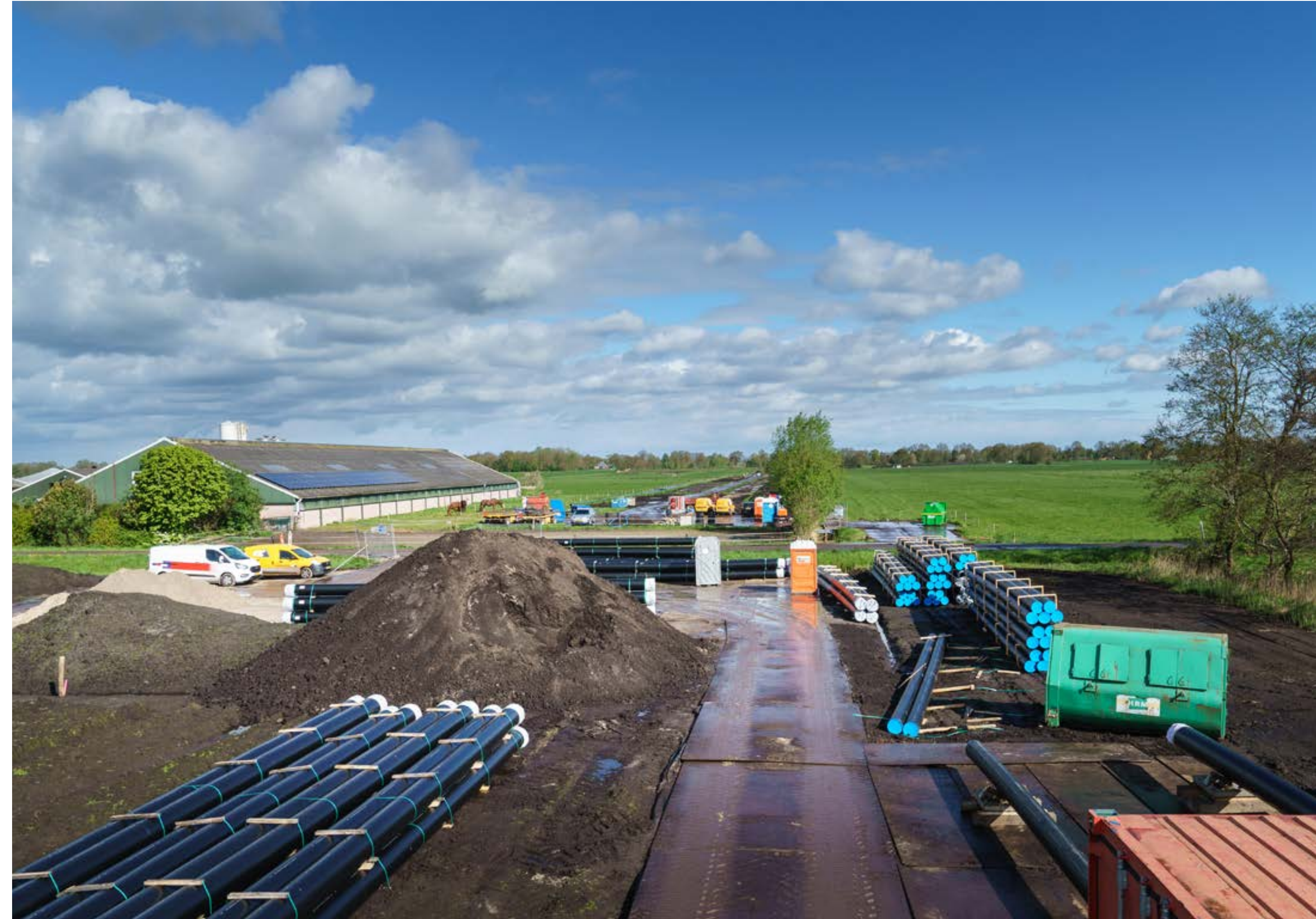
De aanleg van nieuwe persleidingen vordert. Tussen Marum en Gaarkeuken zijn we in voorjaar '24 aan het werk ter hoogte van Lucaswolde.
