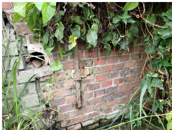
Foto 4.2: Corrosie op anker kade 24 deel 1.
