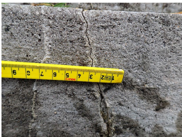
Figuur 4.3: Scheur betonfundering.
