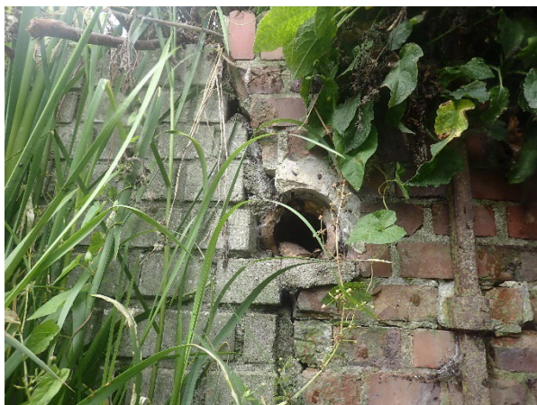
Foto 4.3: Corrosie op anker kade 24 deel 1.
