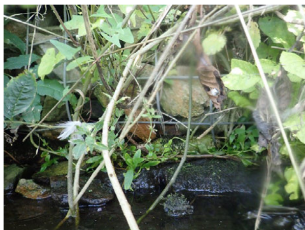
Foto 11.1: Defecte aansluiting schanskorf
