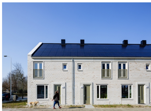
Figuur 2: zonnepanelen geïntegreerd in daken © BASE
