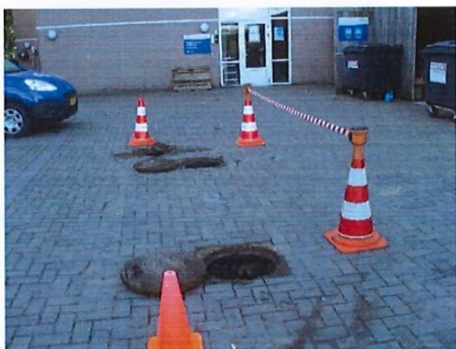
Foto 1 : ligging installatie wasplaats
