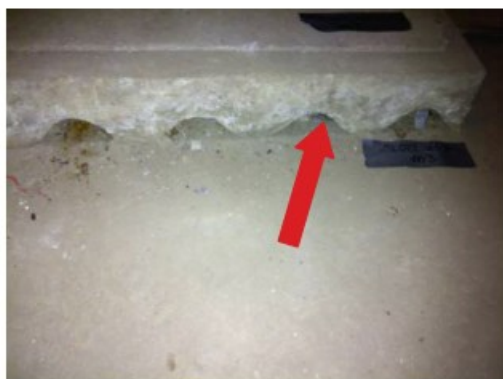
Foto 5 (M3): Golfplaat onder opstorting
