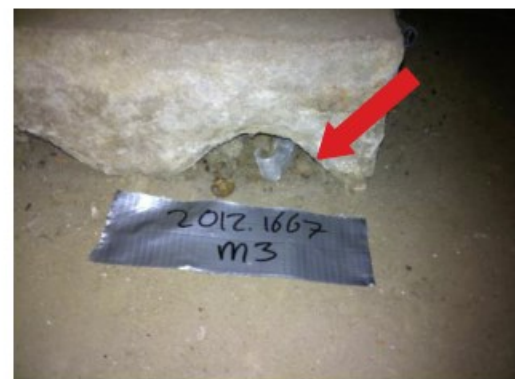
Foto 6 (M3): Golfplaat onder opstorting
