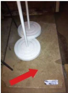
Foto 3 (M2): Losse plaat
