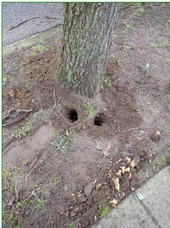
Foto: bij het verrichten van een grondboring onder de stam, wordt gerot hout gevonden
