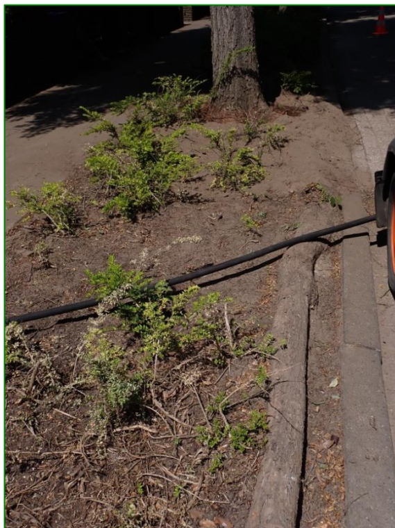
Foto: meters lange, langs het trottoir slingerende grove wortel
