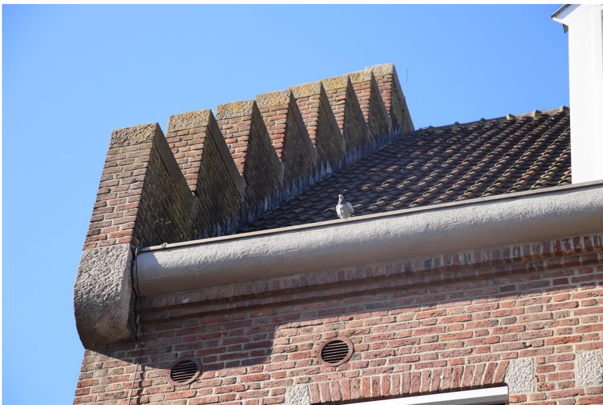
Foto 4: Er zijn geen geschikte invliegopeningen voor gierzwaluwen en deze bouwconstructie is eveneens ongeschikt voor huiszwaluwen
