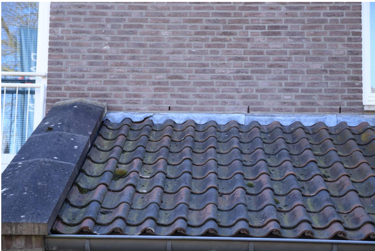
Foto 2: Platte dakpannen geven geen geschikte toegang voor huismussen om er te nestelen.
