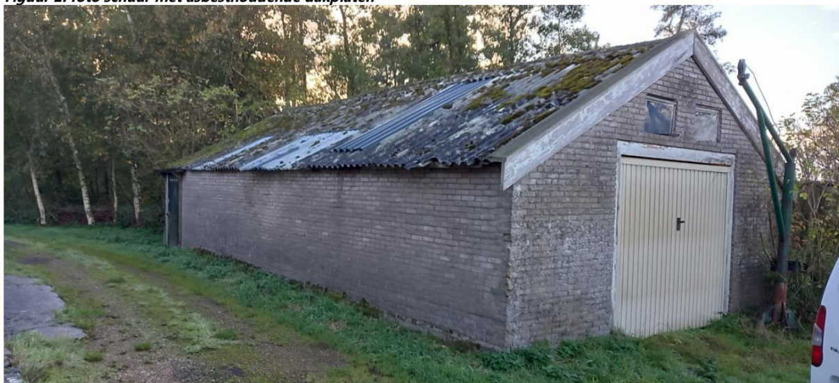
Figuur 2: foto schuur met asbesthoudende dakplaten
