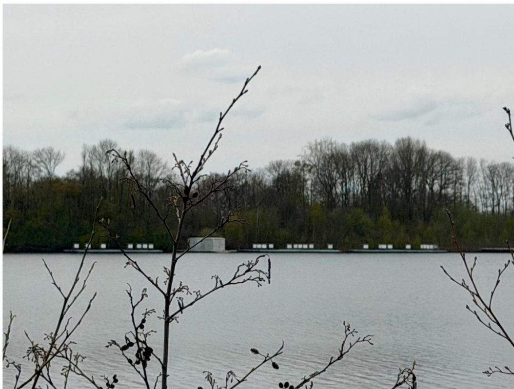
Foto 3: Zicht op de pontons met trafo's en omvormers langs de westelijke oever van de plas.
