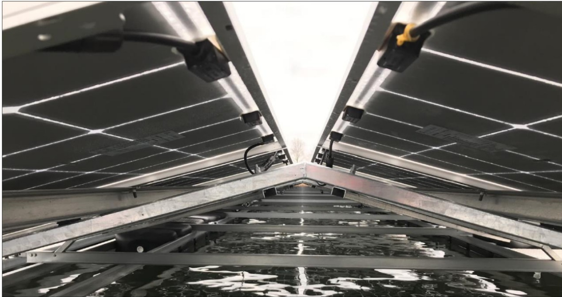
Figuur 5. Lichtstraat zonnepark (bron: Zim Float)
