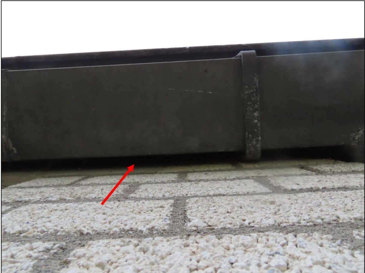
Figuur 2.2. Rond het werkgebouw werden openingen aangetroffen die geschikt zijn bevonden als doorgangen tot verblijfplaatsen van vleermuizen.
