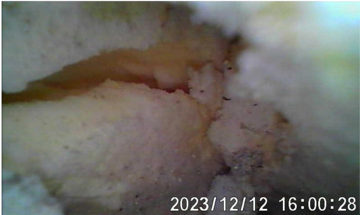
Figuur 20. Verbrokken oud isolatiemateriaal in een spouw.
