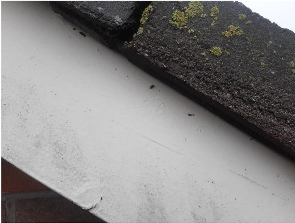
Figuur 14. Enkele uitwerpselen van vleermuizen onder de kantpannen bij een kopgevel.
