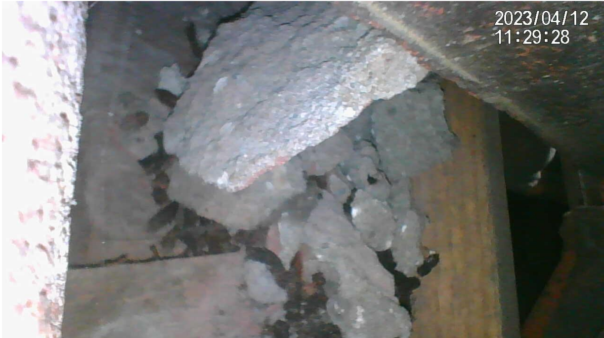
Figuur 6. Uitwerpselen in de spouw van nr. 41, mogelijk van meervleermuis of van laatvlieger. Opname met endoscoop; de uitwerpselen konden niet verzameld worden. De vermelde datum en tijd zijn onjuist (door een verkeerde instelling van de endoscoop).
