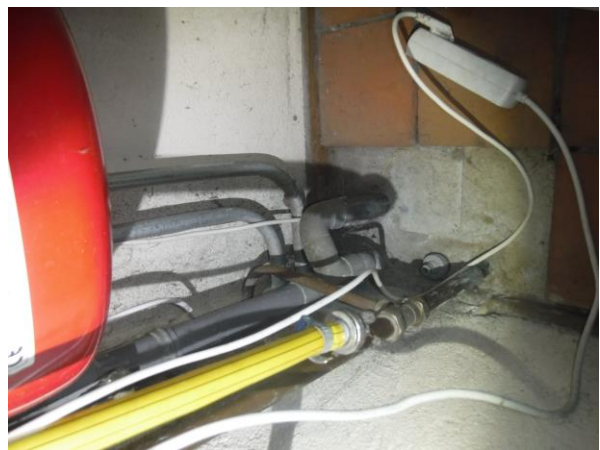
Riool PVC. Onverdacht leidingwerk.
