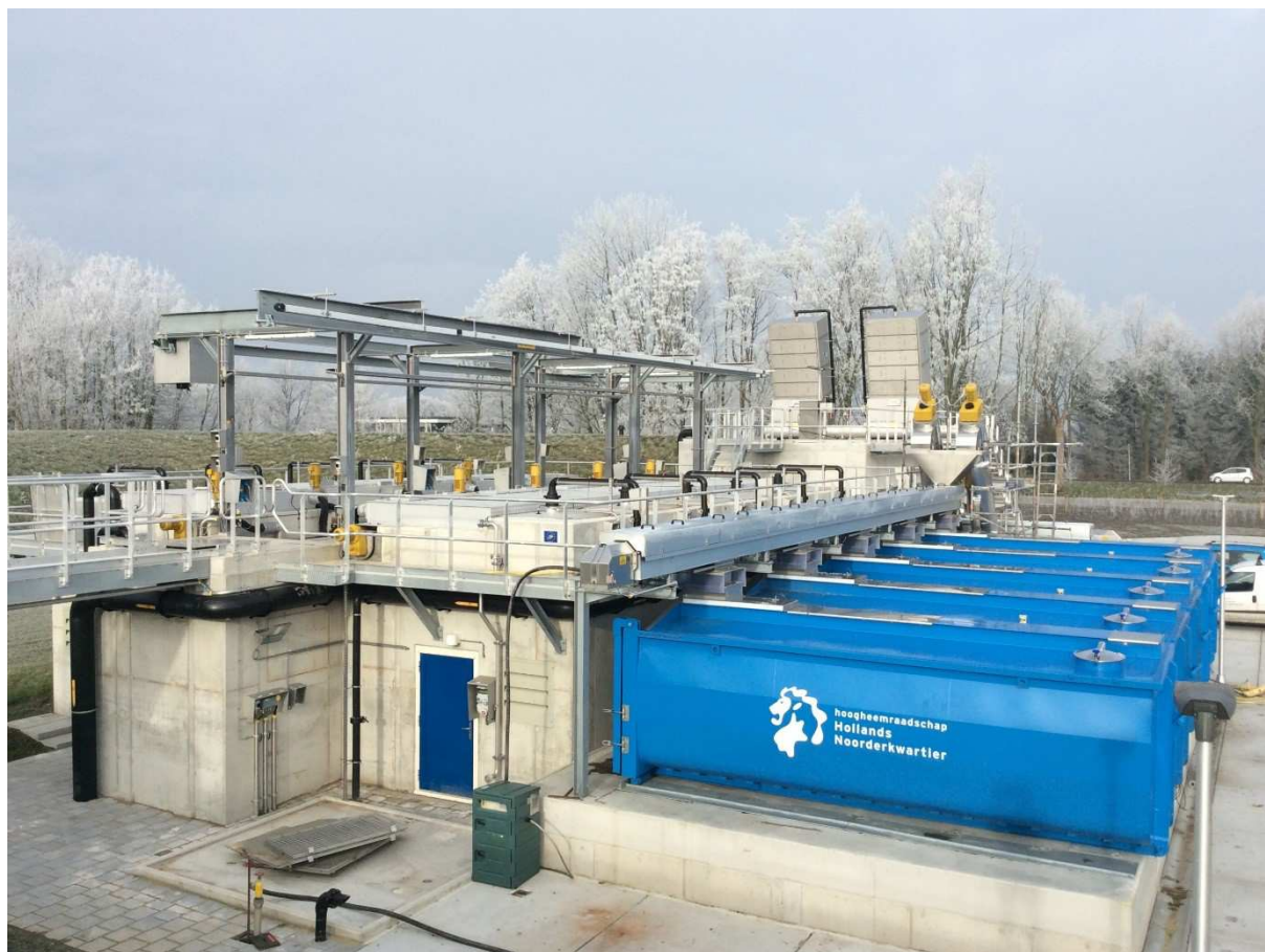
Foto: Fijnzeefinstallatie rwzi Beemster
