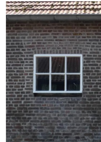
Afb. 41 Inboetwerk boven en links van het venster, links van de deur: sporen van een soortgelijk venster (ca 1900) als rechts.
