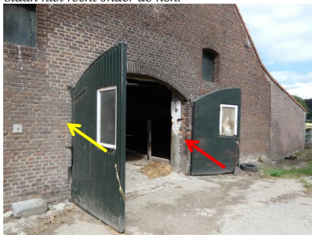
Afb. 128 De poort is in de loop van de tijd aanzienlijk verlaagd. De oorspronkelijke hoogte is aan de buitenzijde nog zichtbaar aan de hoogte van het herstelwerk (grijsere voeg). Langs de poortopening zit een rij klezoren (gele pij). De rode pijl wijst de sponning aan.
