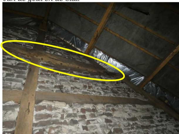
Afb. 53 Staakgaten aan de onderzijde van de dekbalk van het vlieringgebint: sporen van een voormalige lemen wand.
