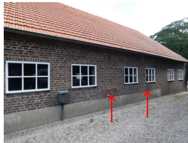
Afb. 22. Betonvensters uit de jaren vijftig-zestig. De rode pijlen geven de locatie van inboetwerk weer.
