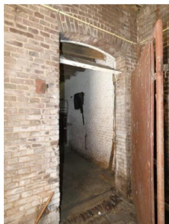
Afb. 167 Rechter staldeur. Het kozijn met tuimelraam is nog aanwezig. De deur en het kalf zijn verdwenen.
