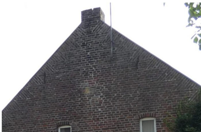
Afb. 12 Geveltop met vlechtwerk en staafankers.
