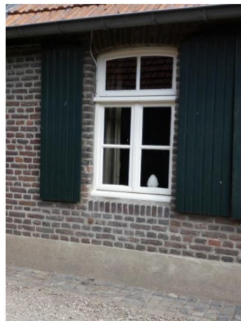
Afb. 19 Venster, links van de deur: onder het venster is sprake van herstelwerk (koppen toegevoegd in de strekkenlaag). Bij de linker dagkant zijn breukstenen aanwezig.
