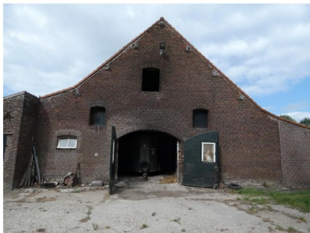
Afb. 127 Achtergevel van de schuur: de gevelopeningen staan niet recht onder de nok.
