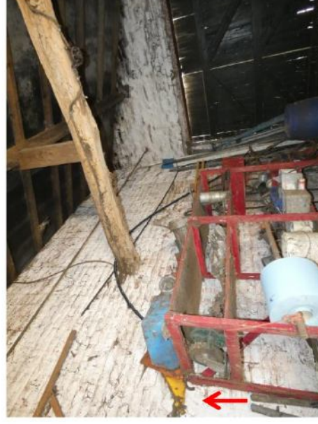
Afb. 116 Geveldeel onder de stal tegen de zuidoost gevel. Linksonder is de segmentboor van een stalvenster zichtbaar.
