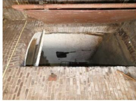
Afb. 167 Rechter staldeur. Het kozijn met tuimelraam is nog aanwezig. De deur en het kalf zijn verduwen.
