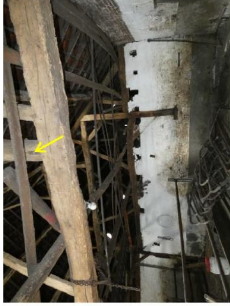
Afb. 147 Oostelijke gebint, noordzijde. Aan deze zijde zit geen tot de grond doorlopende gebintstijl (gele pijl), maar is een jukstijl op de moerbalk gelegd.
