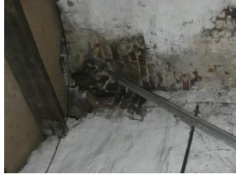
Afb. 199 Sporen van het rookkanaal.
