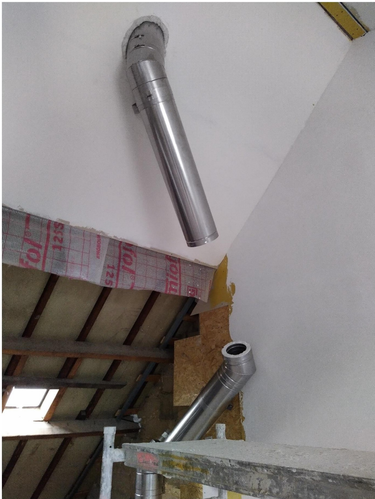
Doorvoerpijp rookkanaal t.p.v. bestaande doorvoer
