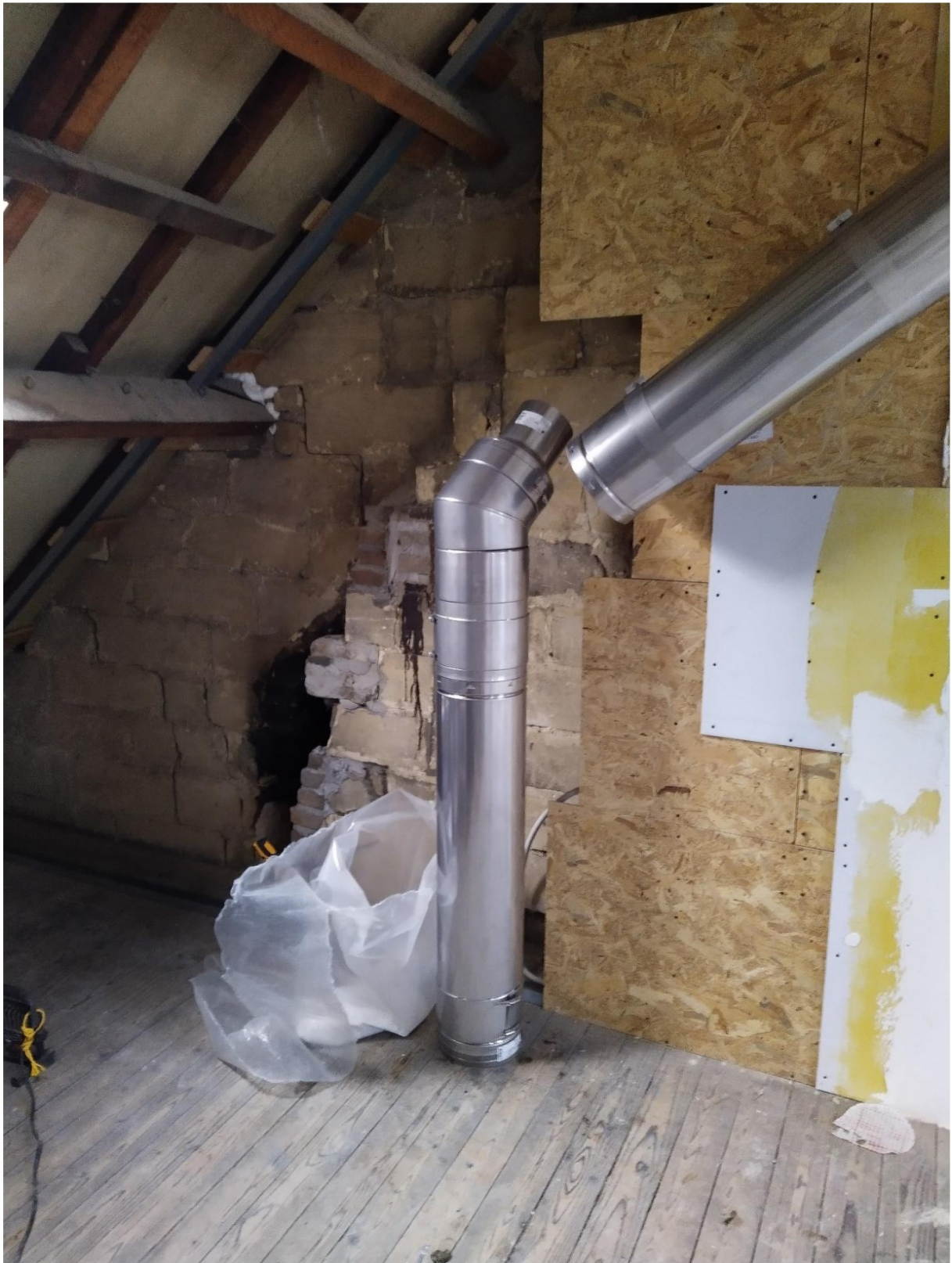
Onderdelen dubbelwandig rookkanaal op zolder
