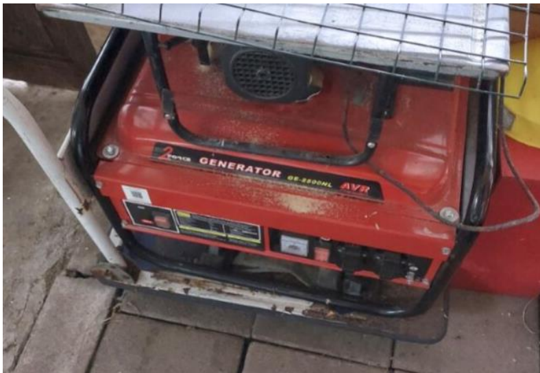
Figuur 3. Aggregaat voor stroom voorziening.
