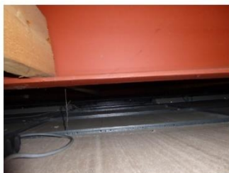
Foto 38: Foto project staal constructie niet omkleed
