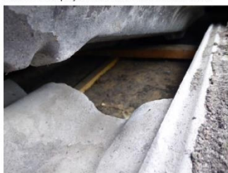
Foto 40: Foto project geen asbest onder dakpannen
