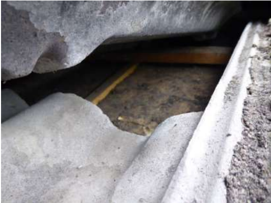
Foto 40: Foto project geen asbest onder dakpannen
