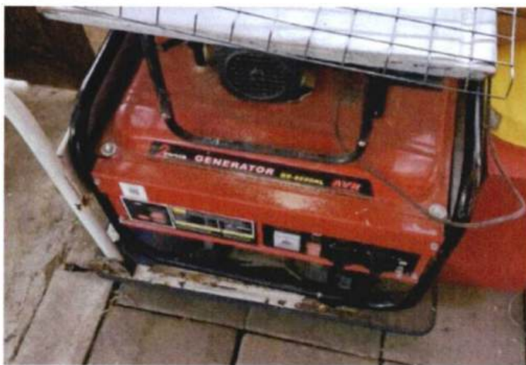
Figuur 3. Aggregaat voor stroom voorziening.
