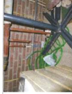
Foto 19 | vlakke plaat verkenningsschot
