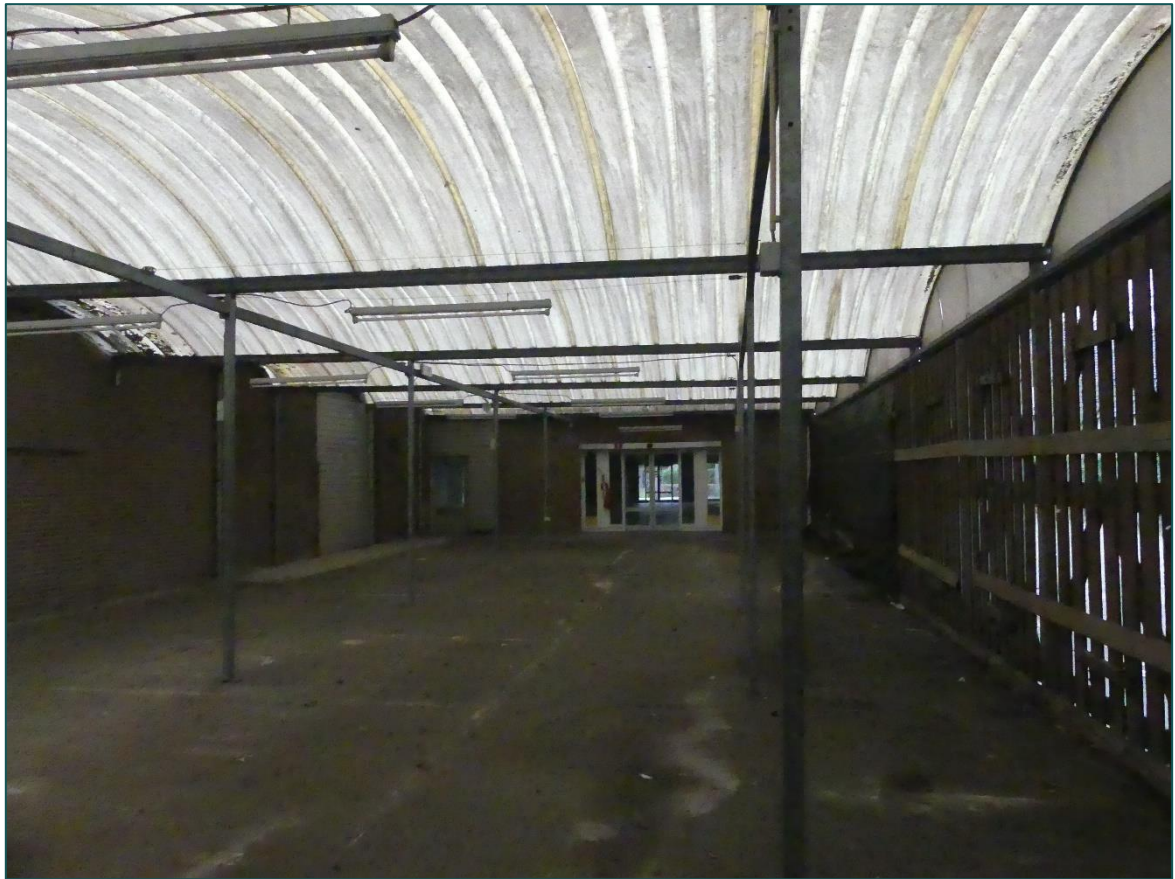
Figuur 3 De overkapping is opgebouwd uit houten wanden en een golfplaten dak.
