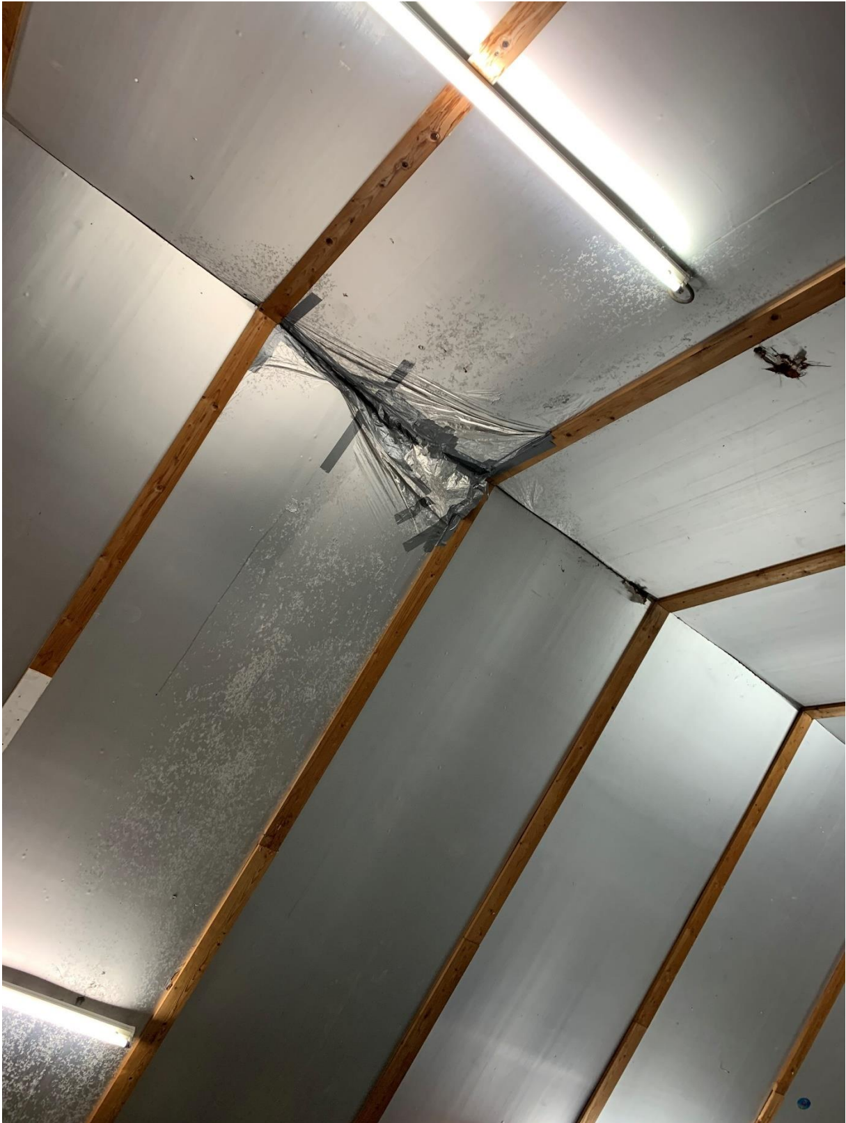
Lekkage (?) in dak van het achterste gedeelte van het pand
