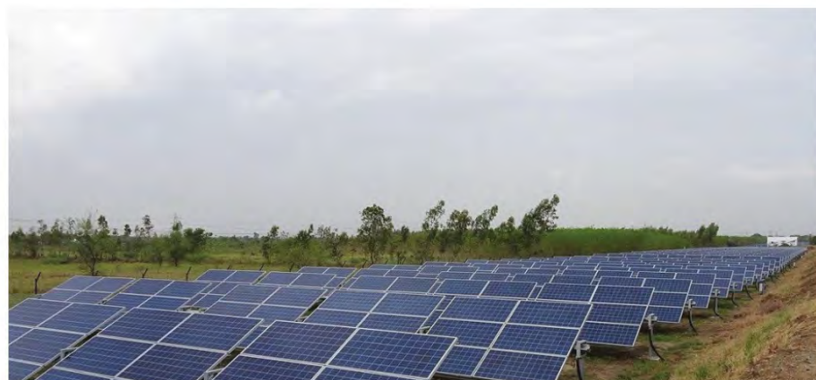
Groen ingepaste veldopstelling met zonnepanelen, Later stadium, Boschweg.
