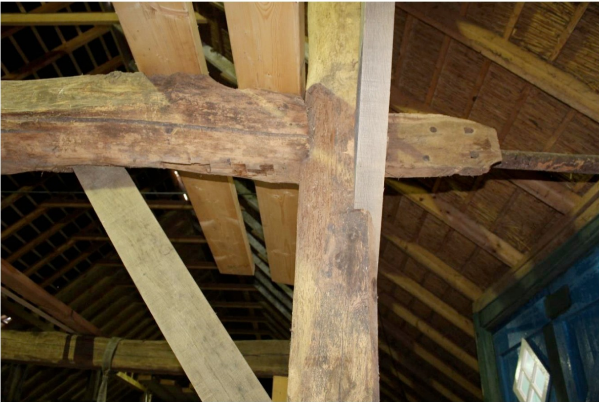
Afb.67 Gebintstel met hergebruikte ankerbalk. Zichtbaar aan de ver doorgestoken pen met toognagelgaten en het lege gat onderin de ankerbalk van de bevestiging van een korbeel in een oudere situatie. We zien ook het jongere korbeel dat tegen de zijkant van stijl en ankerbalk aan is vernageld.
