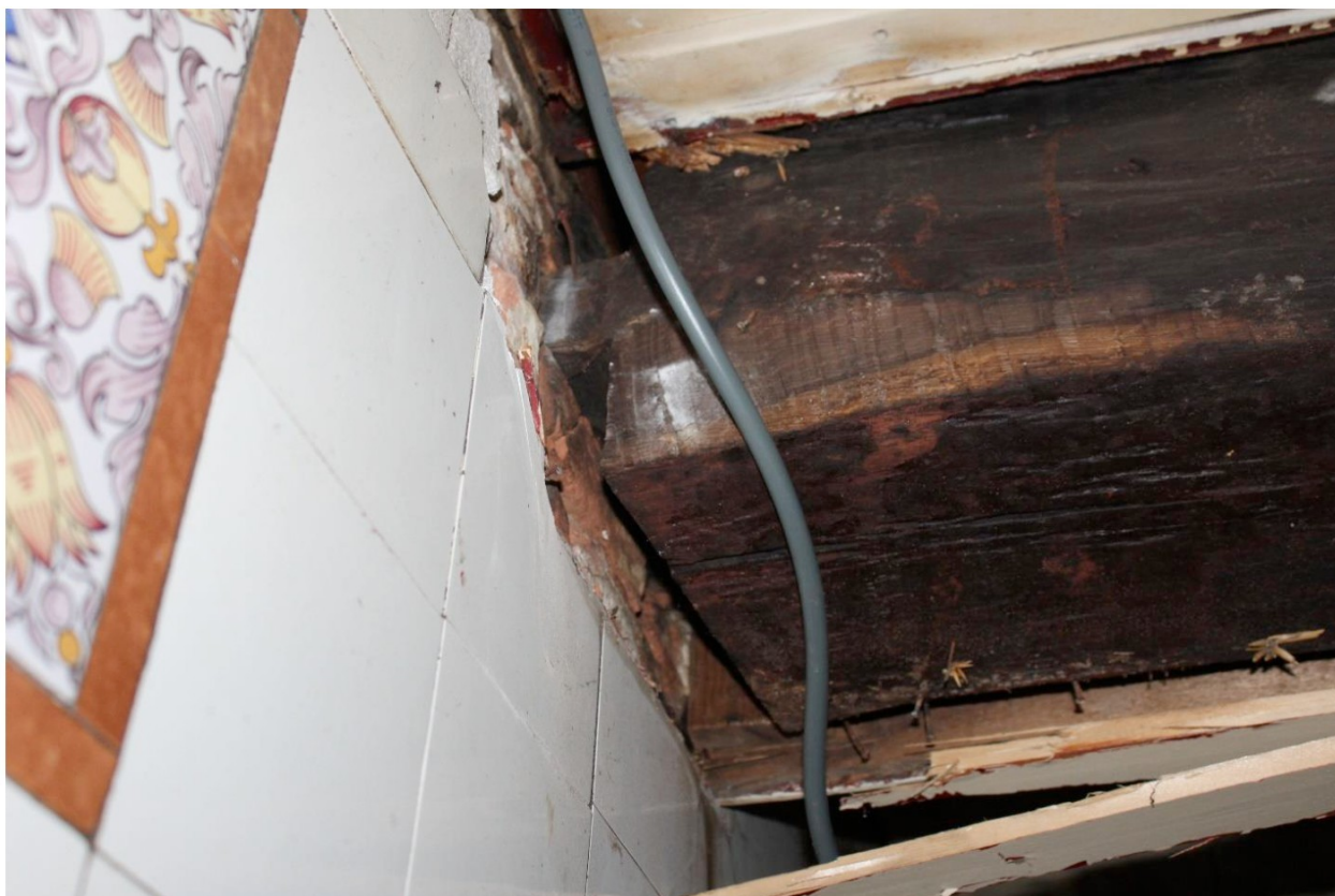
Afb.24 Oplegging in de binnenmuur op de pen van de voorste ankerbalk, linkerzijde. Constructief gezien een zwakke plek.
