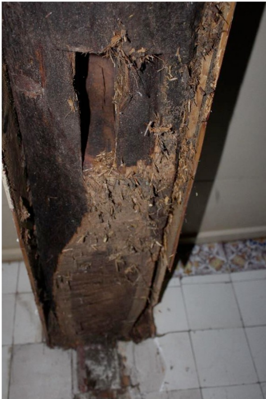
Afb.28 Onderzijde tweede ankerbalk linkerzijde bij de gebintstijl met lege pengat van het voormalige korbeel.
