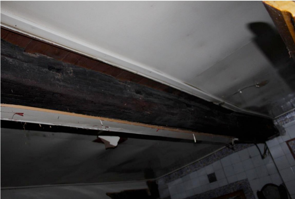
Afb.25 Het verloop van de voorste ankerbalk naar rechts met de lege gaten van de wandconstructie die hier ooit onder heeft gestaan.
