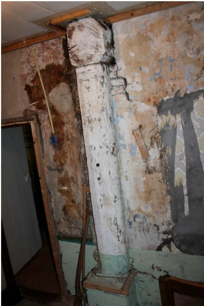
Afb.27 Zicht op de afgezaagde kant van de tweede ankerbalk met halve stijl eronder op een poer tegen de binnenmuur aan.
