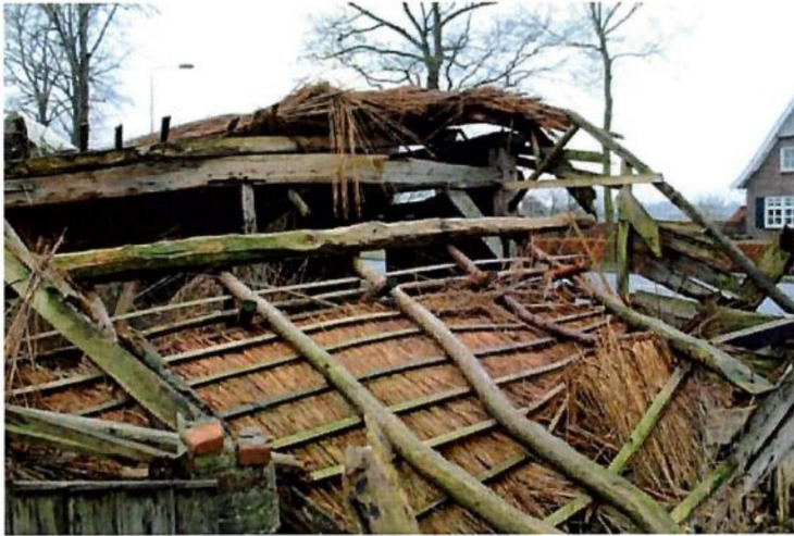
Foto ingestorte kap zuidgevel
