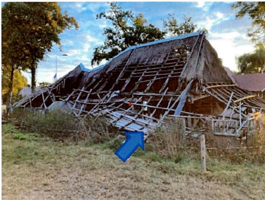
De bouwkundige staat van de schuur in 2022 (foto [REDACTED])
