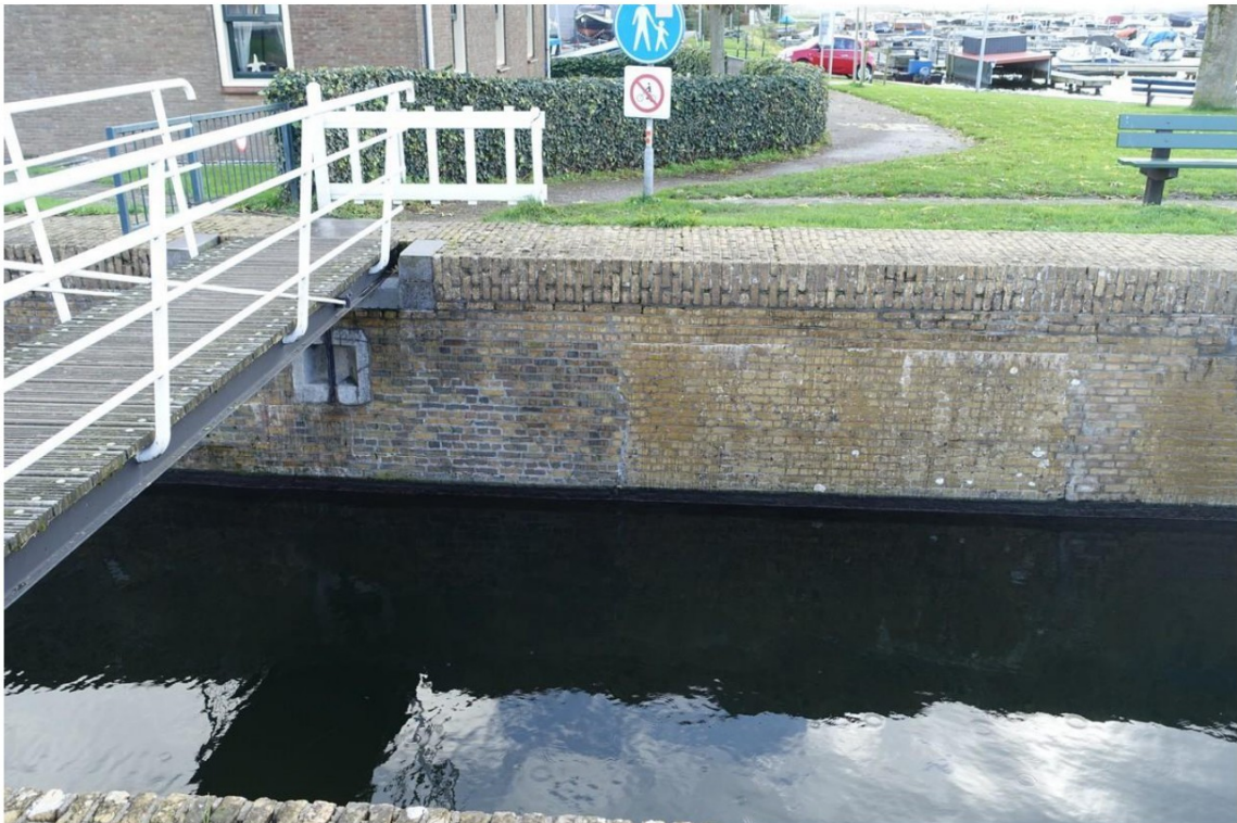
De brug die direct boven de derde haalkom ligt, een nogal ongelukkige plaats. Op de tekening van rond 1815 ligt deze meer naar rechts. De oplegging is in de rollaag ingebroken en met nieuwe hardstenen blokken omlijst. Direct naast de brug is er een deels paarskleurige steen toegepast.
