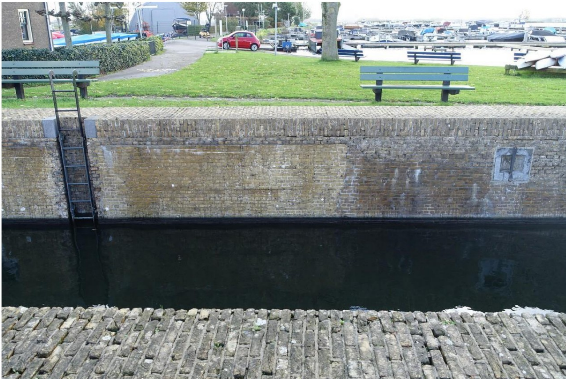
Links van de bank een duidelijke overgang in het metselwerk met een zeer rommelig uitgevoerde overgang aan de rechterzijde. De stalen ladder is waarschijnlijk in 1977 in het bestaande metselwerk ingebroken. Het nieuwere werk van de rollaag tekent zich ook duidelijk af.
