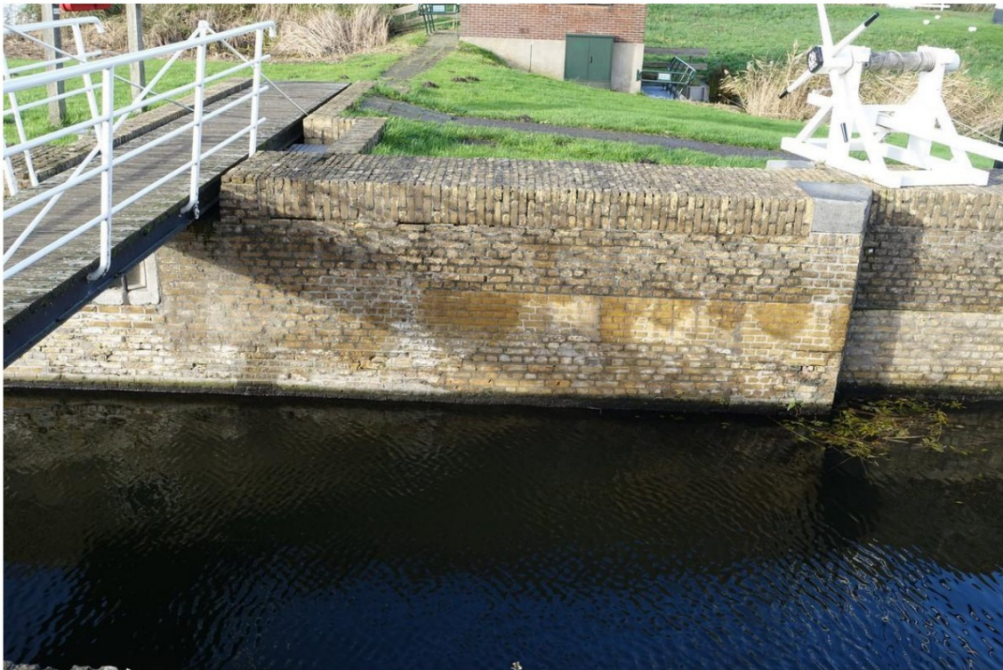
Het metselwerk rechts van de brug laat een grote variëteit aan herstellingen zien die niet even fraai zijn uitgevoerd. Anderzijds laat dit wel zien dat er met regelmaat onderhoud is uitgevoerd.
