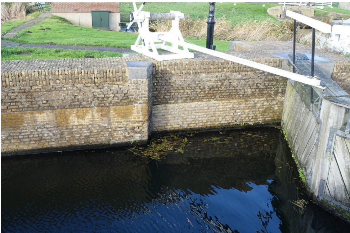
Rechts de deurkas met erboven de kaapstaander. Boven het lichtere werk de herstellingen uit 1977 met donkere cementmortel.
