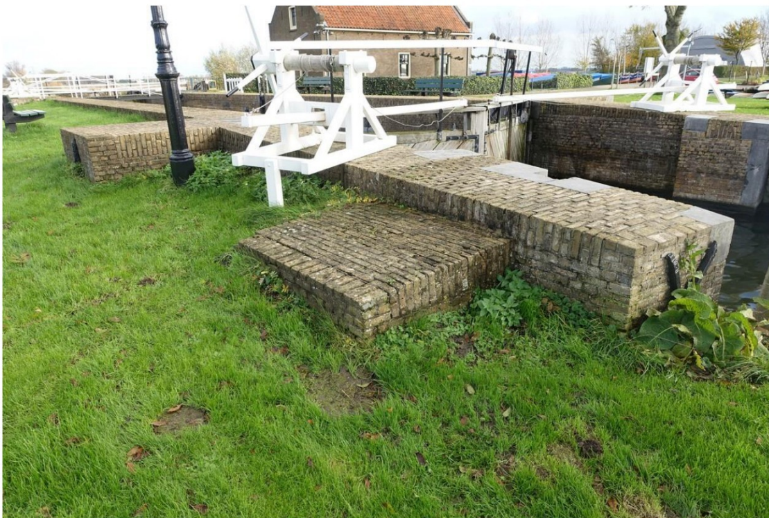
De westelijke zijde van het bovenhoofd. Hier ontbreken de hardstenen blokken aan de buitenzijde van de sluiswand. Op de kop van de wand is een zwaar kruisvormig muuranker aanwezig. In de steunbeer bij de deuren ook een zwaar exemplaar, maar dan met een rechte schieter.
