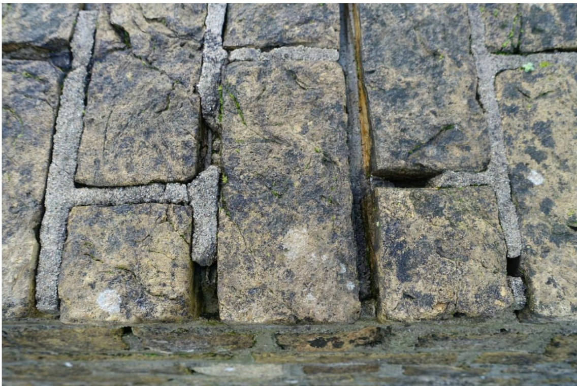
Het metselwerk van de rollaag aan het westelijke benedeneinde. De bakstenen zijn in 1976-1977 nieuw aangebracht. Aan het slijpspoor is te zien dat het voegwerk waarschijnlijk in 2007-2008 is vernieuwd. Intussen is dit weer aan herstel toe.
