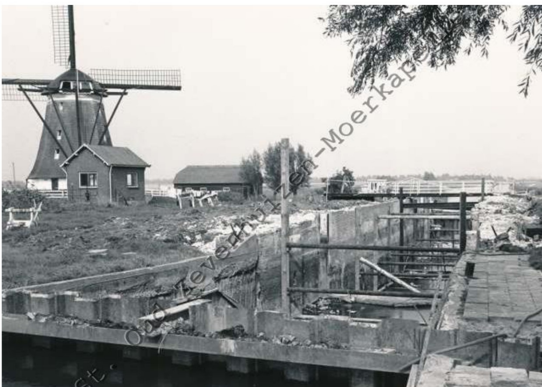
Foto van de historische vereniging van de restauratie uit 1976-1977, waarbij goed zichtbaar is dat er forse herstellingen zijn uitgevoerd (OZM 10745).
