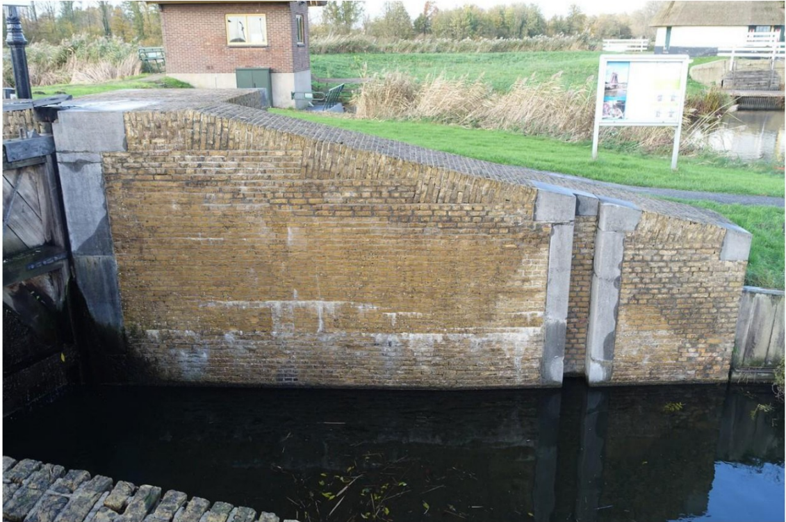
Het benedenhoofd met ook hier de duidelijke aftekening tussen het werk met cementmortel aan de bovenzijde en ouder werk.
