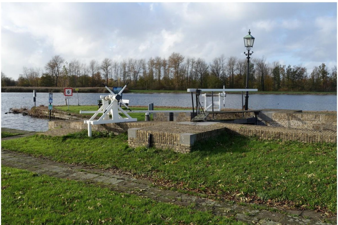
De oostelijke zijde van het bovenhoofd met de steunberen aan het begin van de sluis en bij de deur. Op alle hoeken zijn hardstenen blokken geplaatst om het losraken van stenen te voorkomen. Gezien de op veel plaatsen geheel uitgespoelde voegen van de rollaag geen luxe. Aan de westelijke zijde zijn niet overal hardstenen blokken op de hoeken aanwezig.
