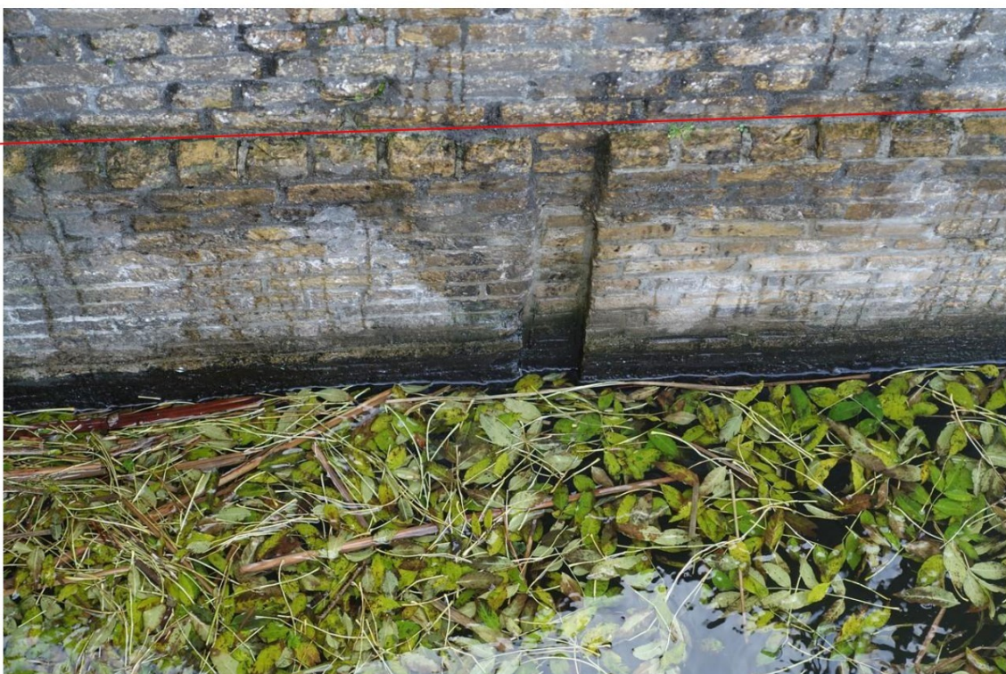
De sparing die in het metselwerk van de deurkas is gekapt voor de heugelstang. Dit laat duidelijk zien dat de heugelstang een latere toevoeging is. De opening van het rinket verloopt er wel gemakkelijker mee dan met de constructie op de tekening van rond 1815. Ter plaatse van de rode lijn verjongt de wand van de deurkas een halve steen. Alle deurkassen hebben dit, blijkbaar een bouwspoor van oudere deuren.
