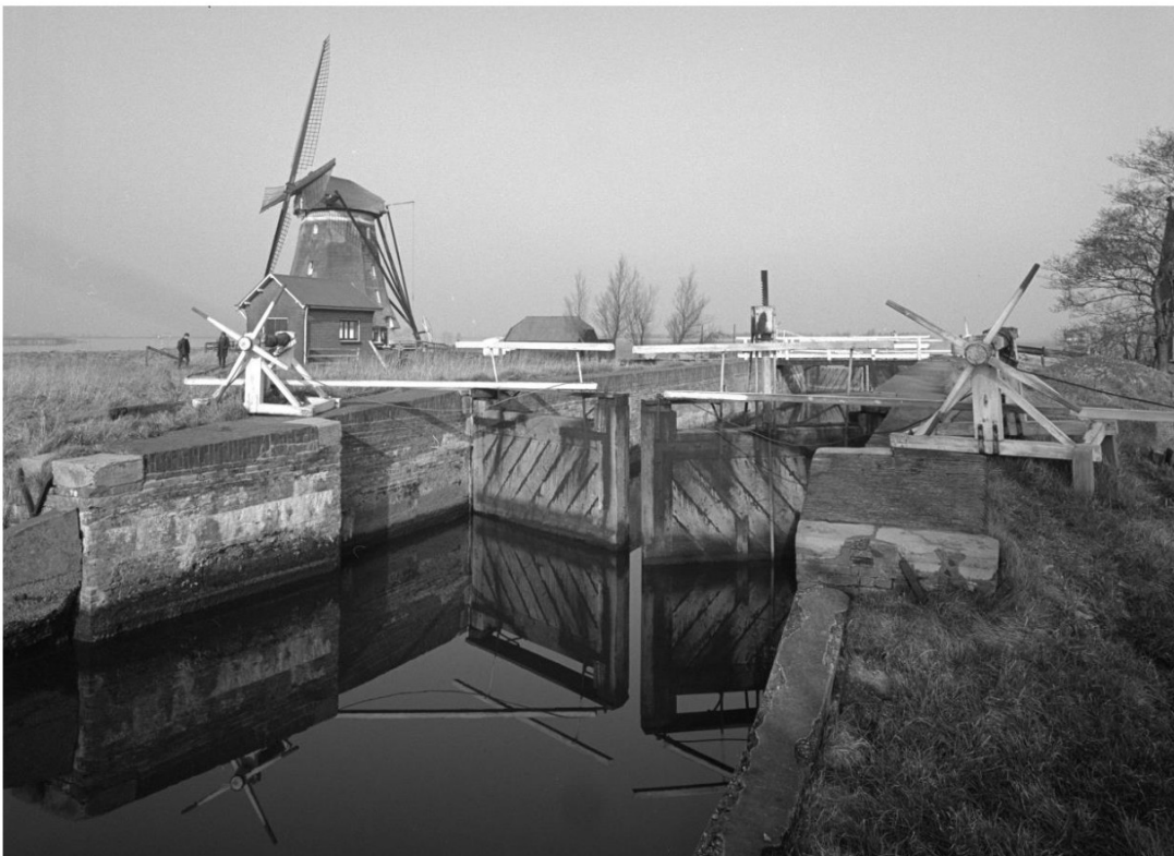
Foto uit 1967 van het bovendee van de sluis (RSA 4121-5141-1-01 Ary Groeneveld). De staat van het metsel- en natuursteenwerk is slecht.
