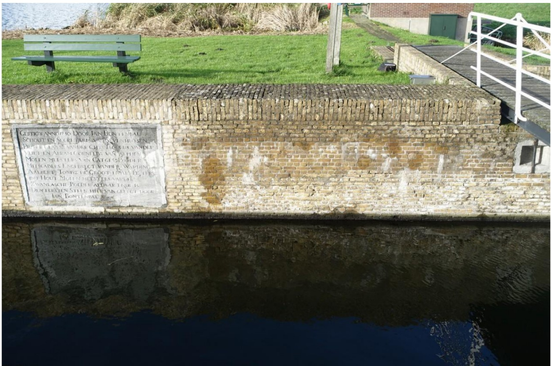
Rechts van de gedenksteen is ook een brede band metselwerk vernieuwd. Ook is hier goed zichtbaar dat er voor de schuivende brug een doorbraak in de rollaag is gemaakt.
