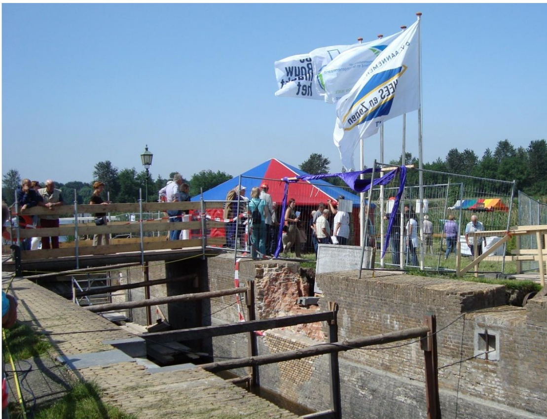
Foto van de restauratie van 2007-2008 met ter plaatse van de gedenksteen een grote opening die aan de onderzijde reeds is ingeboet. Hierboven zijn de rode bakstenen aan de binnenzijde goed zichtbaar.
