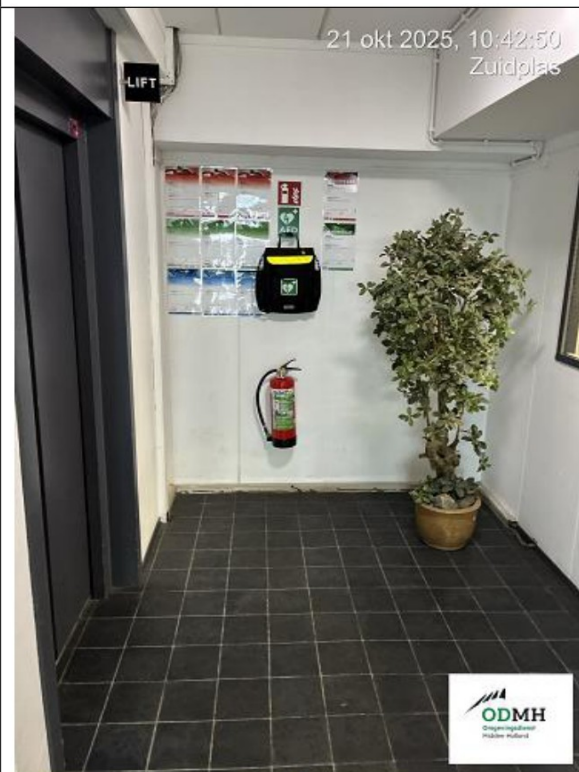
Verkeersruimtes zijn niet voorzien van rookmelders
