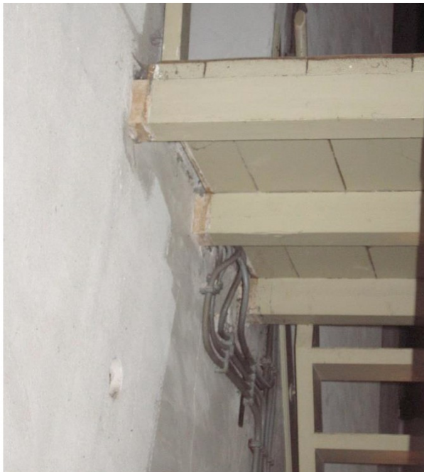
Balklaag bordes komt los uit toren
