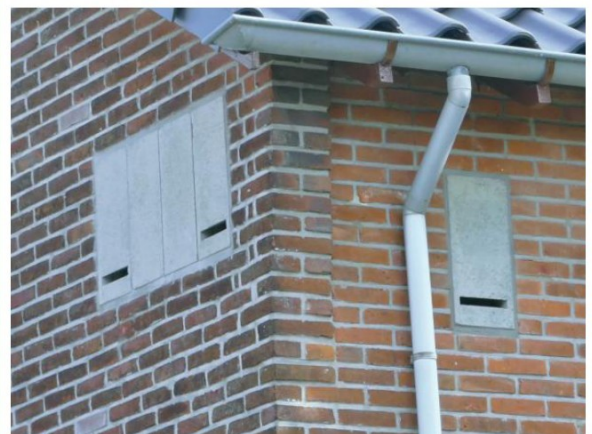
Ingebouwde neststenen voor vleermuizen. Foto: Habitat Ecologie.
