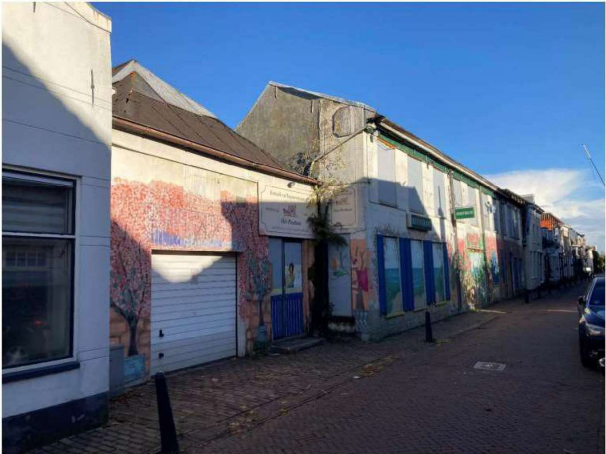
Foto 5, voorzijde ingang, dak is dicht
