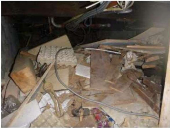
Ruimte vol puin en afval in de kelder.
