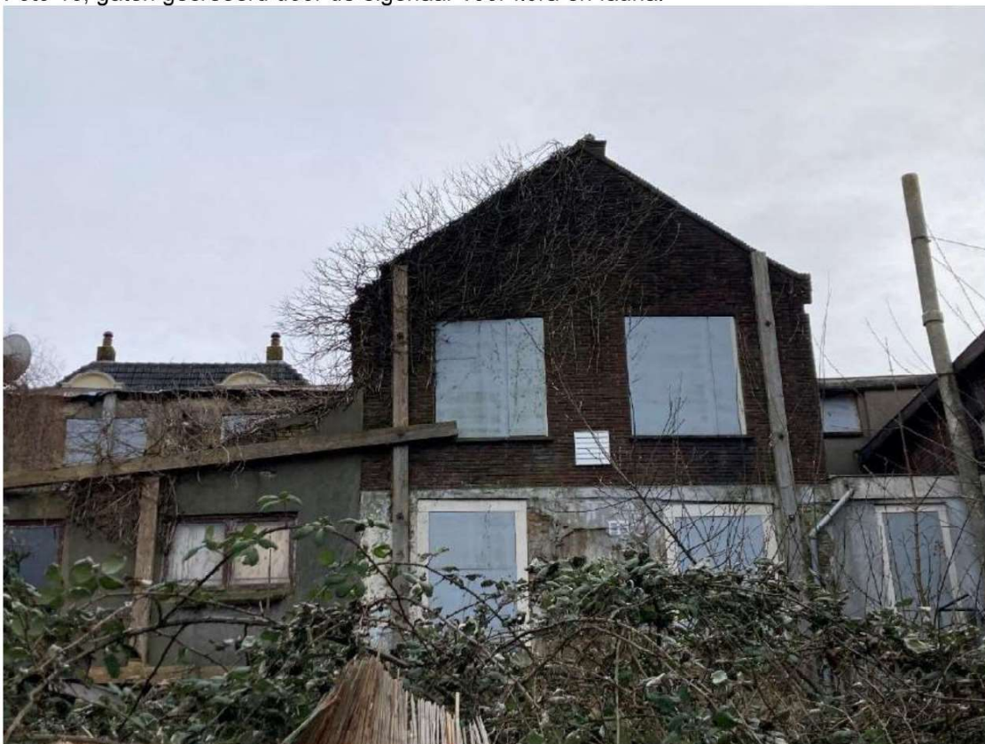
Foto 11, balken buitenzijde tegen de gevel.
