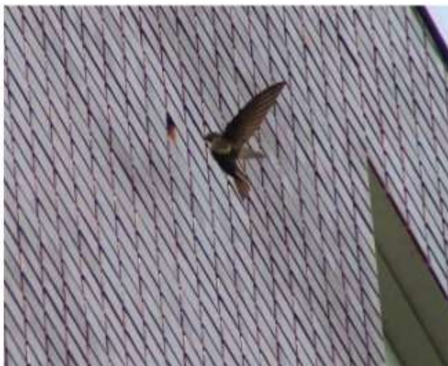
Gierzwaluwsteen weggewerkt in gevel
