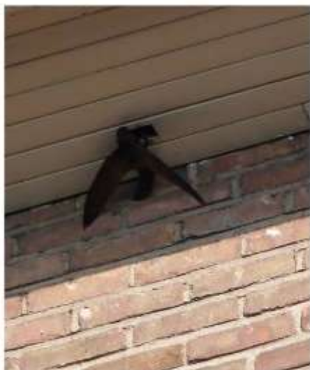
Gierzwaluwsteen weggewerkt in dakrand
