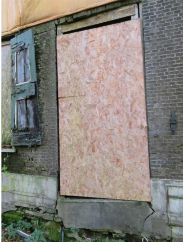
Beschadigd muurwerk rond de deur in de noordwestgevel
