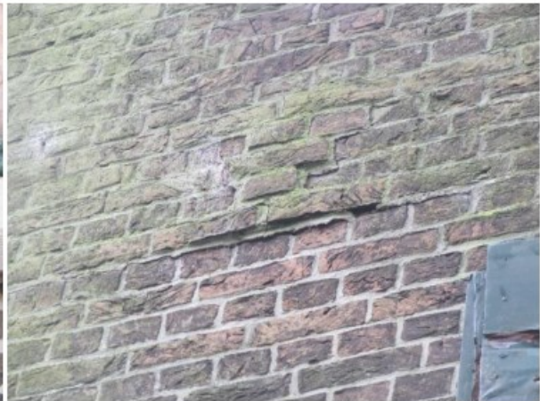
Opbollend metselwerk t.p.v. een roestend blindanker
