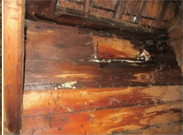
Gevelbeplanking aangetast door houtrot en zwam
