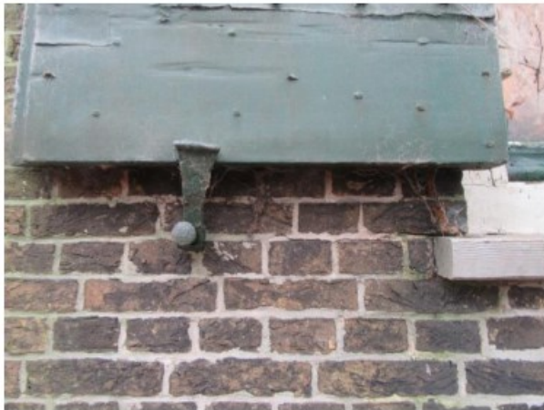
Scheur door corrosie van de luikwartel
