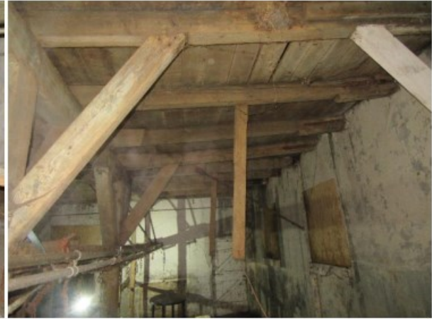
Balklaag zoldering stal sterk verzakt
