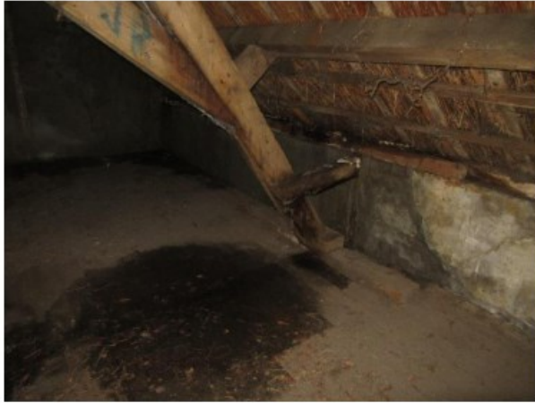
Spant, blokkeel en muurplaat hier sterk aangetast
