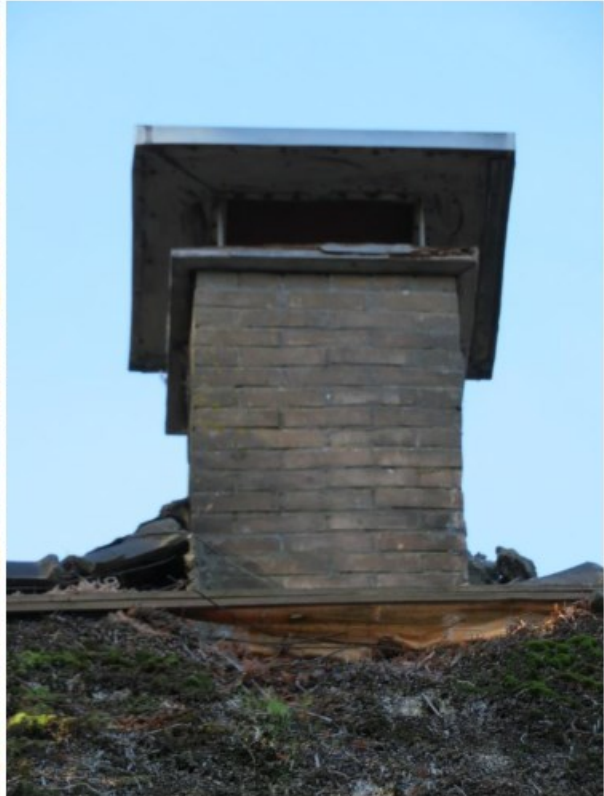
Schoorsteen komt omhoog t.o.v. dak, kap ingerot
