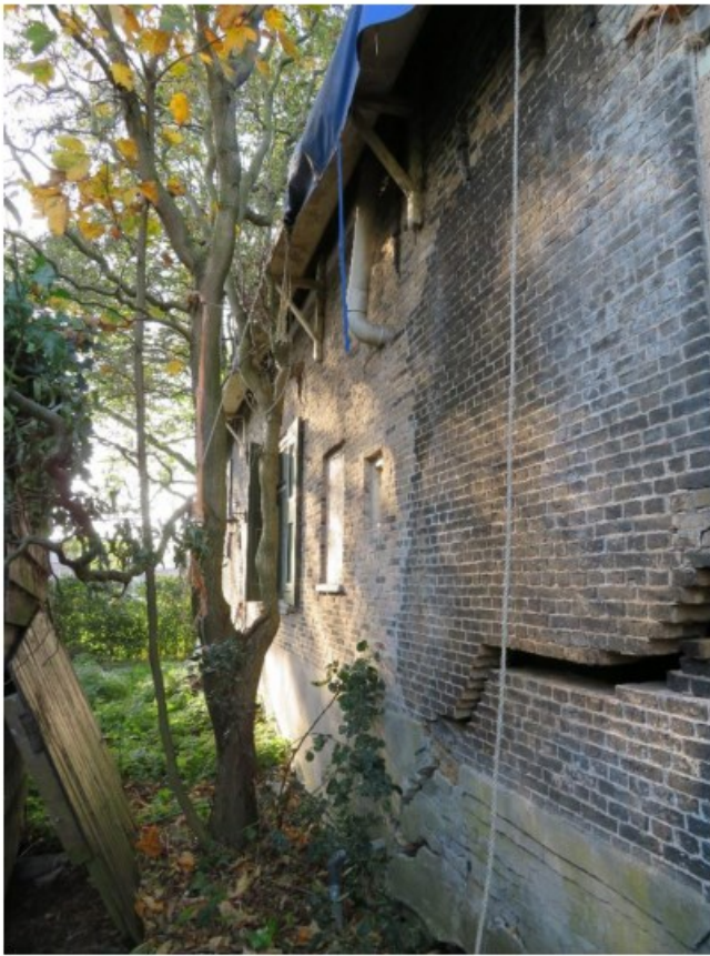
Scheuren rechter zijgevel (06-11-2020)
