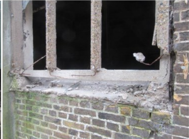
Schade aan het beton van de stalramen.
