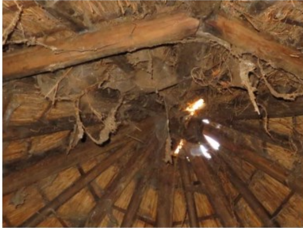
Dak karnhuisje lekt, constructies aangetast door vocht
