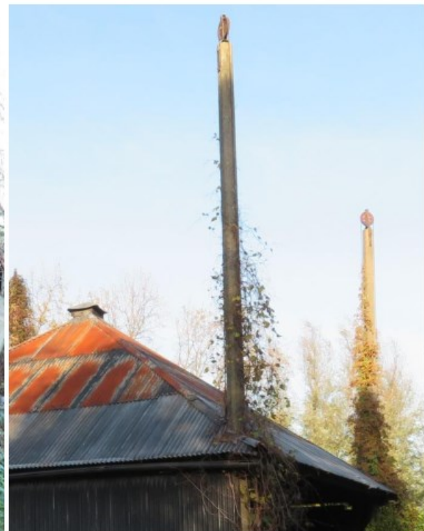
Roeden hooiberg overwoekerd; dakplaten gecorrodeerd
