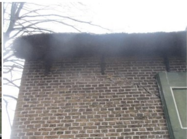
Muurwerk hoek zuidoostgevel /voorgevel ontzet
