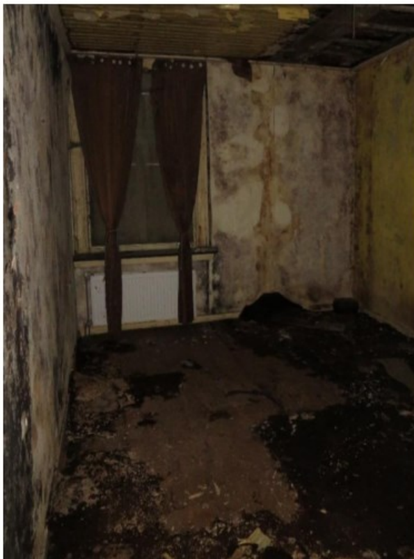
Vloer woonhuis verzakt en aangetast
