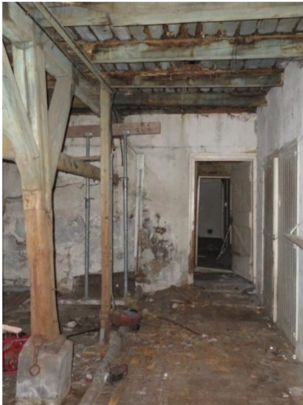
Balklaag en zoldering aangetast
