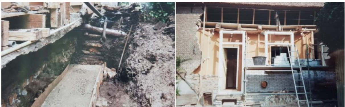
De aanleg van de betonnen fundering en het optrekken van het kalkzandsteen binnenblad. (collectie familie Reijm)
