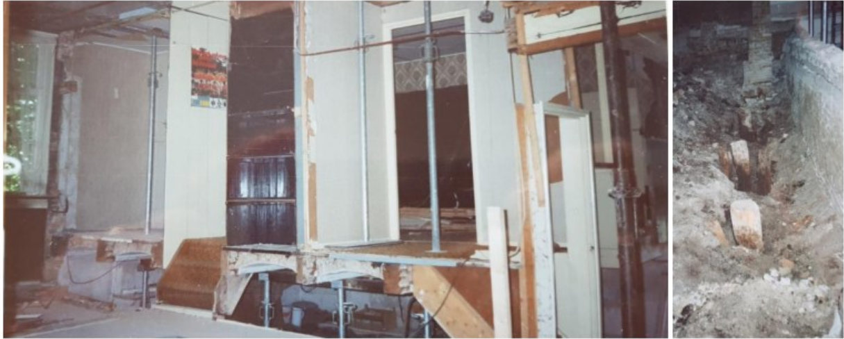
De afbraak van de muur tussen de aan de voorgevel georiënteerde woonvertrekken en de paalfundering daaronder. (collectie familie Reijm)
