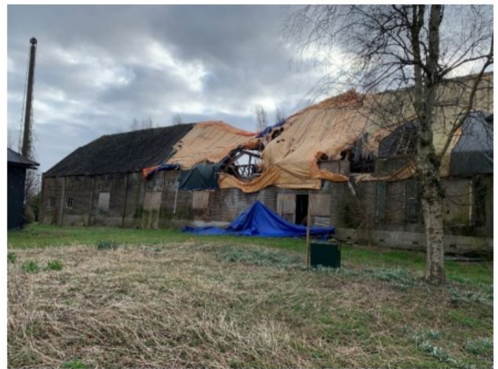
Huidige situatie: Stabilisatie is hard nodig
