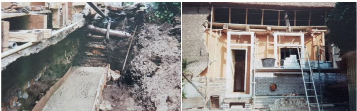
De aanleg van de betonnen fundering en het optrekken van het kalkzandsteen binnenblad. (collectie [REDACTED])
