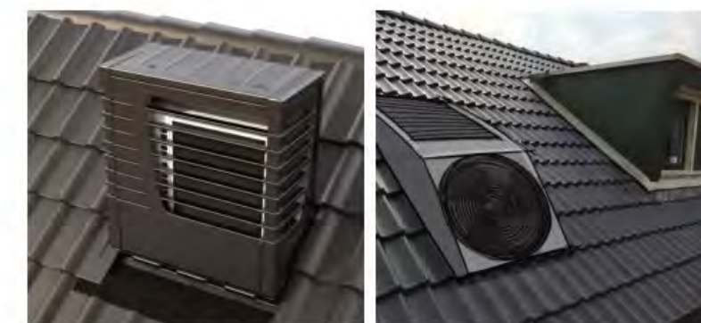
Buitenunits geïntegreerd in het bouwvolume
