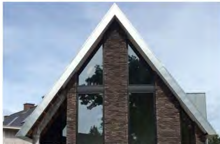
Strak vormgegeven windveer als dakoverstek bij de kopgevel
