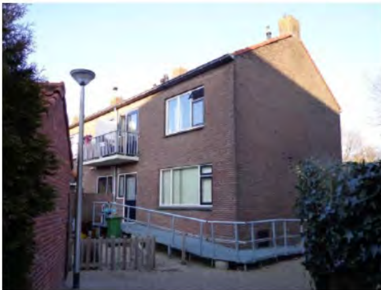
Huidige situatie waarbij woningen moeilijk toegankelijk zijn door verzakking. (Bron: Stedenbouwkundig plan BDP Rotterdam)
