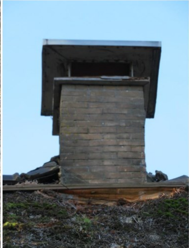
Schoorsteen komt omhoog t.o.v. dak, kap ingerot
