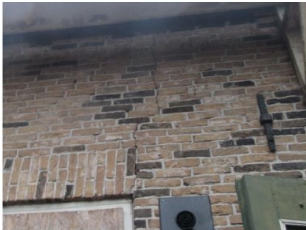
Scheur in het nieuwe muurwerk van de zuidoostgevel
