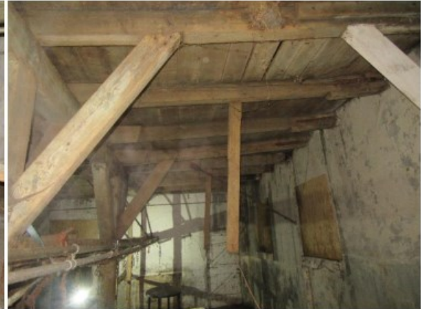
Balklaag zoldering stal sterk verzakt
