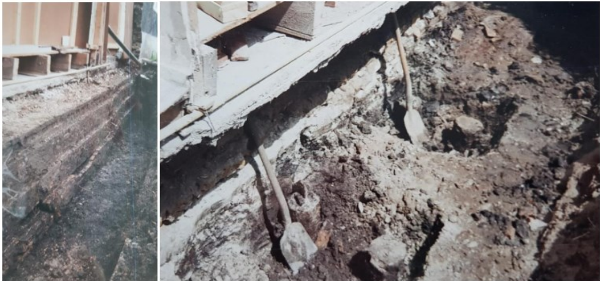
De sloop van de gevel, tot aan de fundering (links) en tot op de palen (rechts). (collectie familie Reijm)
