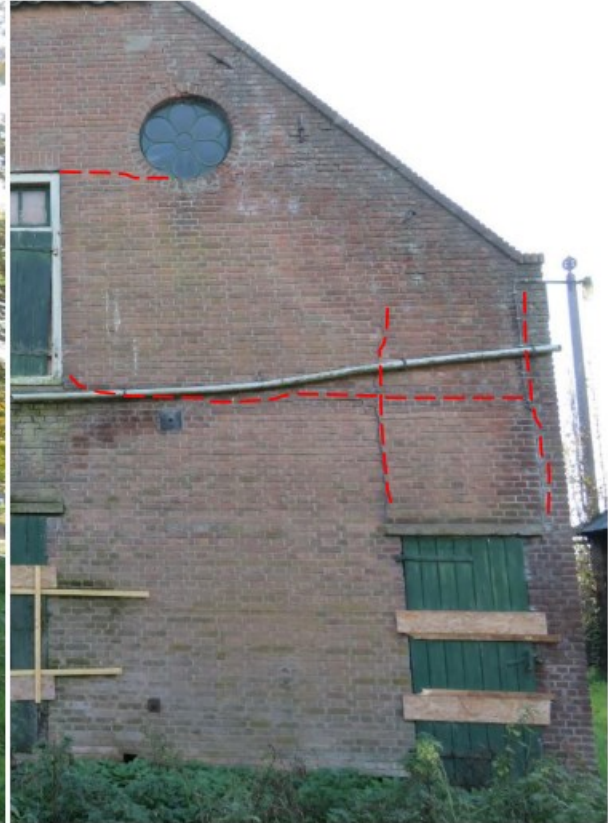
Verticale en horizontale scheuren in achtergevel.
