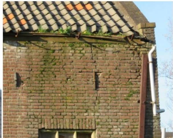
Scheurvorming, slecht voegwerk en anker in zuidoostgevel
