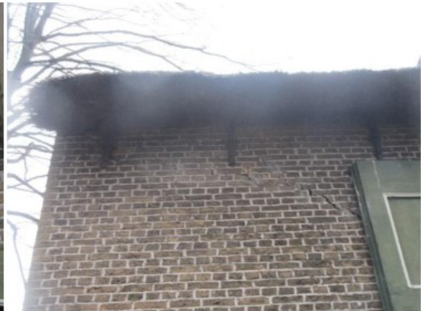
Muurwerk hoek zuidoostgevel /voorgevel ontzet
