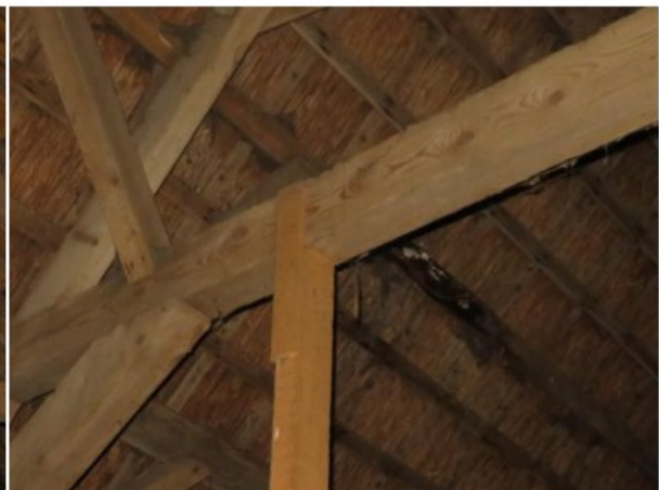
Plaatselijke aantasting gording, t.p.v. lekkage
