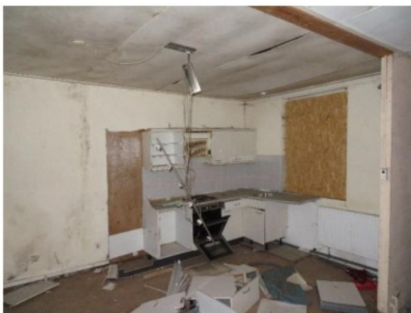
Afwerkingen interieur beschadigd en beschimmeld
