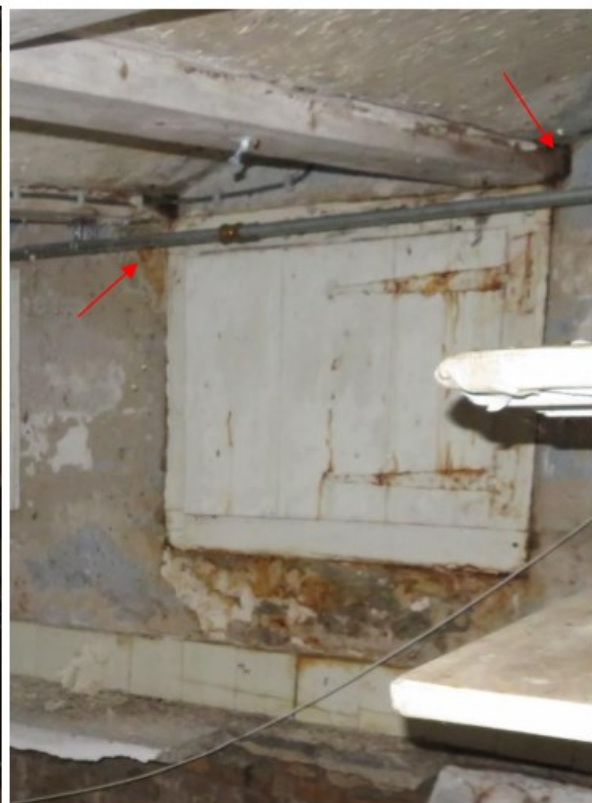
Kopen houten balklaag boven kelder aangetast
