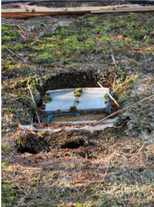
Riet verweerd en lek t.p.v. zuidoostelijk dak woonhuis
