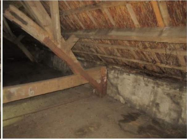
Spant aangepast, stalen trekstang. Muurplaat rot
