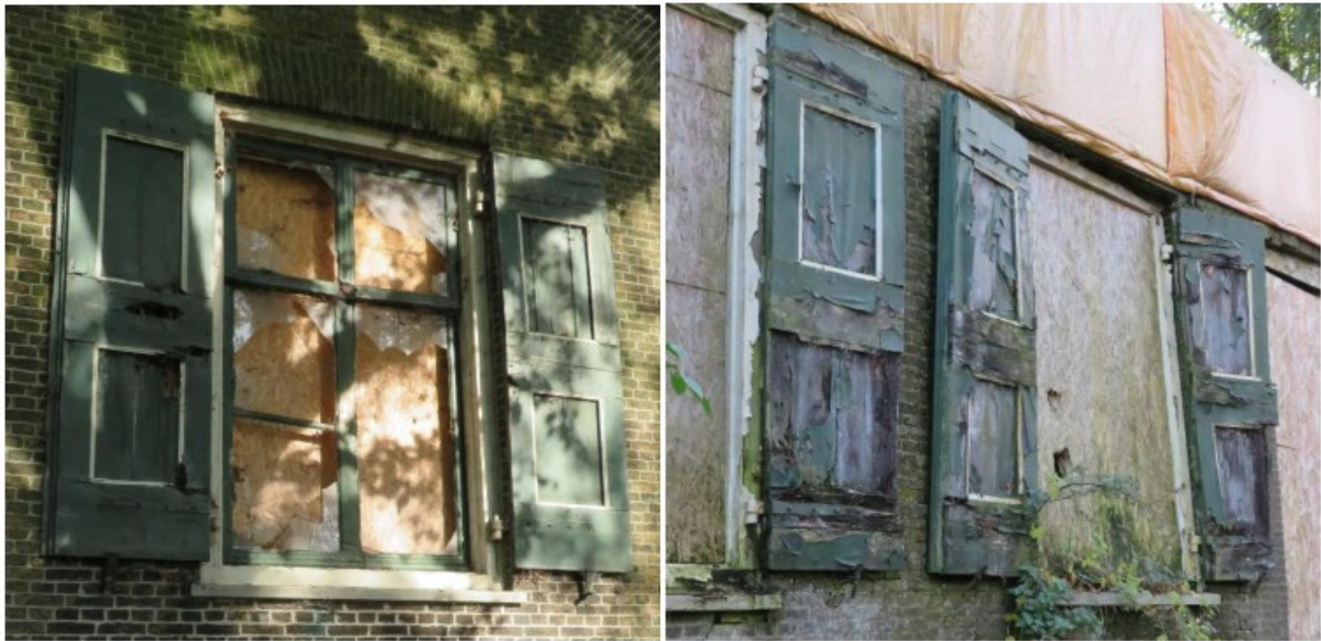
Schade aan raamhout en luiken van één van de ramen in de voorgevel; ramen in noordwestgevel sterk aangetast
