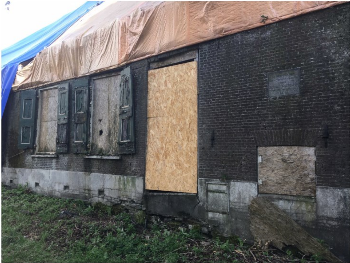
Foto 1, deur dichtgezet met plaatmateriaal
