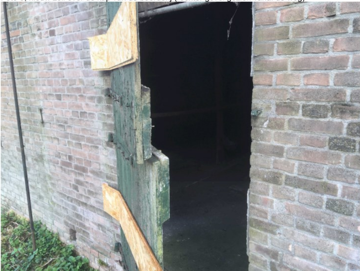
Foto 4, achterzijde stal deel, deur open gebroken.
