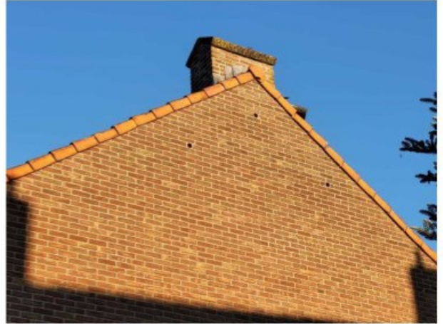
Figuur 6: Schielandstraat 1: gevel met gaten
