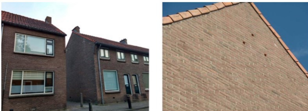
Figuur 9: Schielandstraat (l) en Gaten in kopgevel blokken Schielandstraat en Sluislaan (r)
